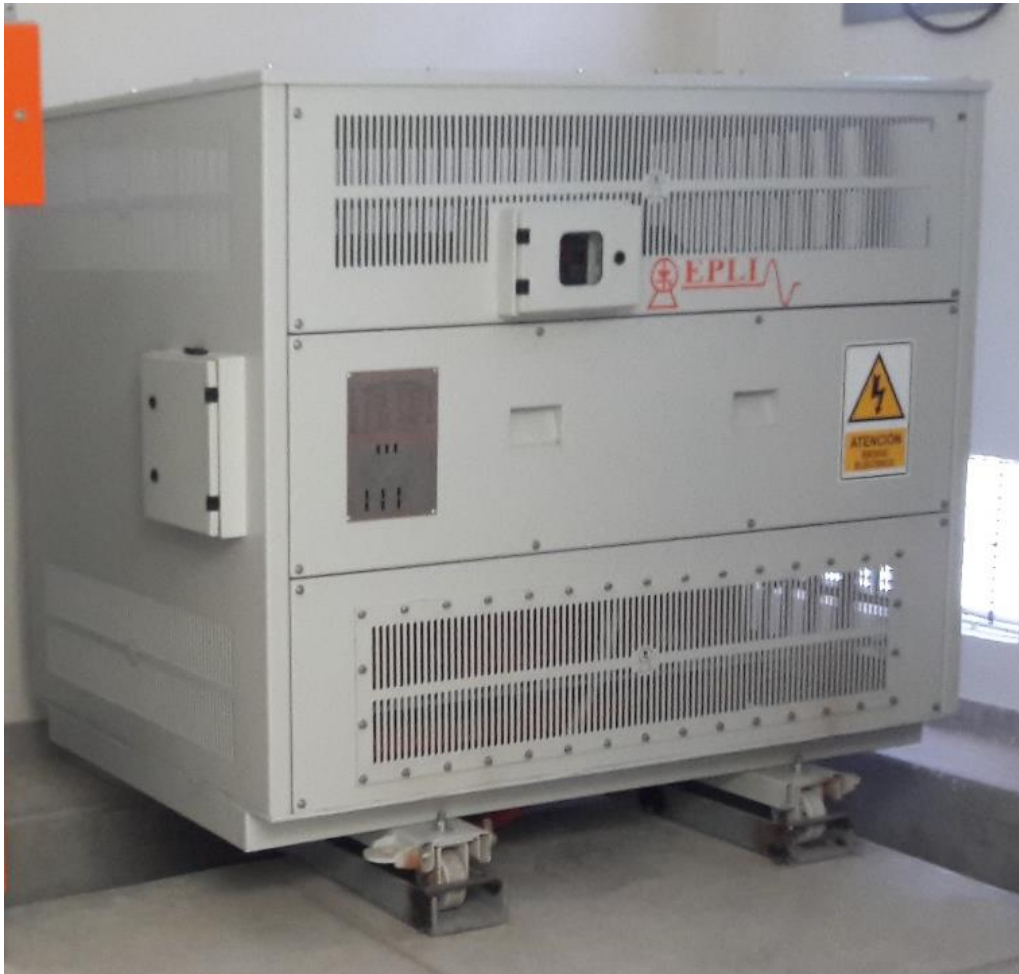
Figura 7 Transformador Trifásico seco encapsula en resina epoxi Fuente: EPLI SAC
