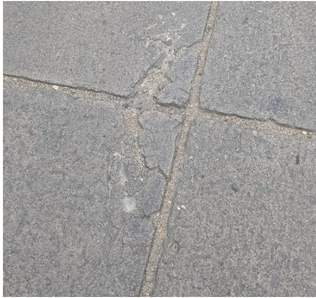
Figura 16. Descascamiento de Esquina
