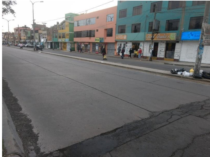
Figura 6. Av. Los Alisos: Inicio la Evaluación PCI Calle Jaime Bauzate Mesa
