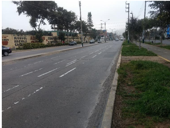
Figura 9. Identificación de daños encontrados.
