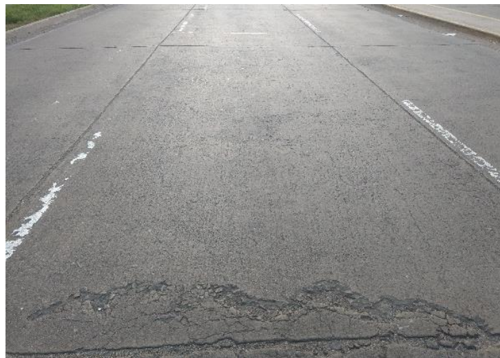
Figura 15. Desconchamiento / Mapa de grietas / craquelado
