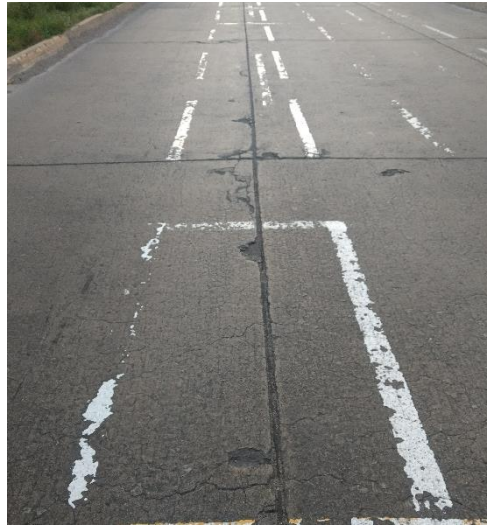
Figura 10. Grieta de esquina
