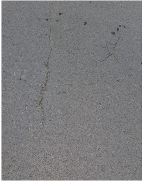
Patologías encontradas en la carretera interoceánica
