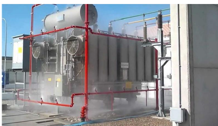
Figura 25 Sistema de diluvio para protección contra fuego en transformadores
