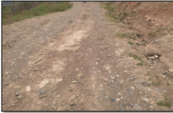
Foto 17: km 00+900 – 00+960 se identificaron daños como la erosión y deformación en la carretera.
