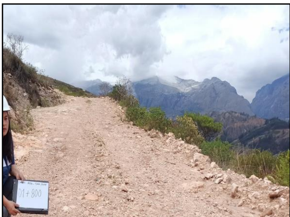
Foto 21: kilometraje 1+800 – 1+850, se identificó daños como erosión y deformación en la carretera.
