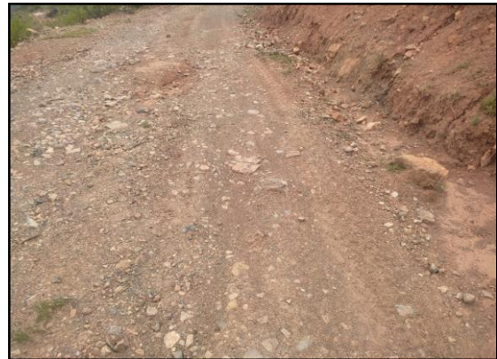
Foto 20: en el kilometraje 1+155 de la carretera se identificaron daños como la erosión y deformación de la carretera.
