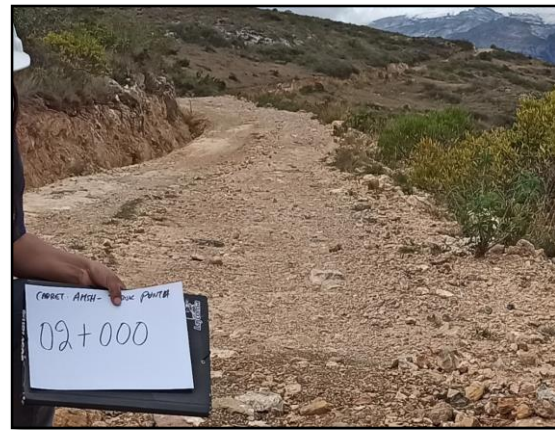
Foto 22: kilometraje 02+000, medición de daños como erosión en la vía.
