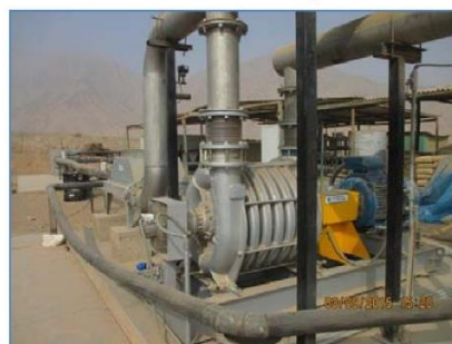
Planta de tratamiento de biogás
