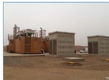
Unidades de Generación y Transformadores
