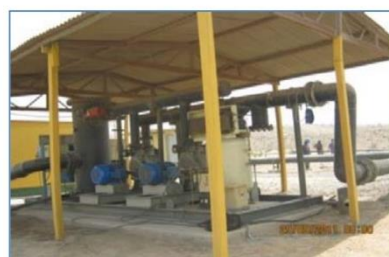
Planta de tratamiento de Biogás
