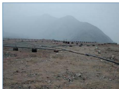
Pozos de extracción de gas
