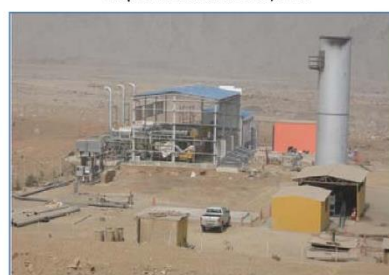
Central Termoeléctrica Huaycoloro
