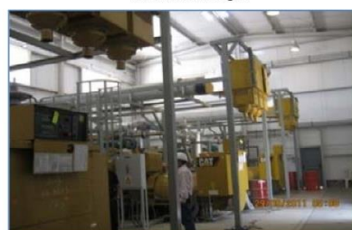
Grupos de Generación 3 x 1,6 MW
