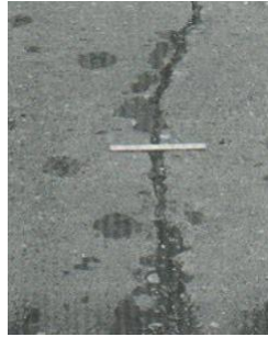
Figura 17. Grietas lineales de severidad media en losa de concreto reforzado
