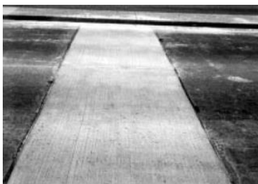
Figura 18. Parcheo mediano de mediana severidad
