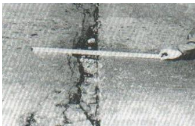
Figura 28. Descascaramiento de junta de alta severidad
