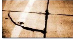
Figura 11. Grieta de esquina.
