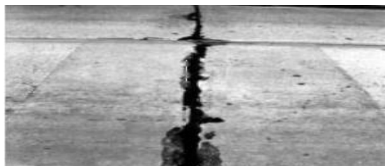
Figura 15. Deterioro del sello de la junta mediana severidad
