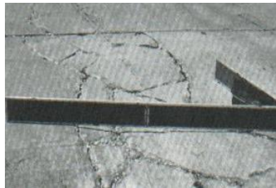
Figura 23. Punzonamiento de alta severidad.
