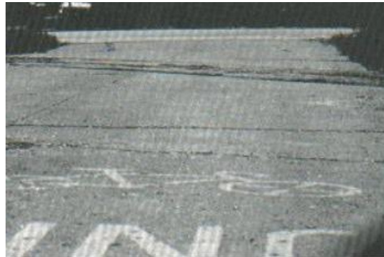
Figura 24. Cruce de vía férrea de severidad media
