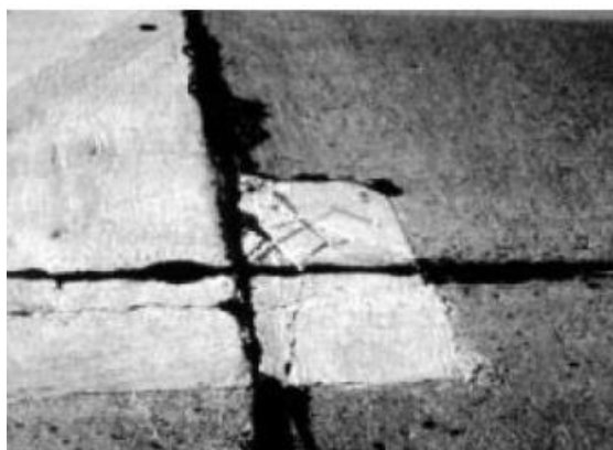
Figura 19. Parcheo pequeño de mediana severidad.
