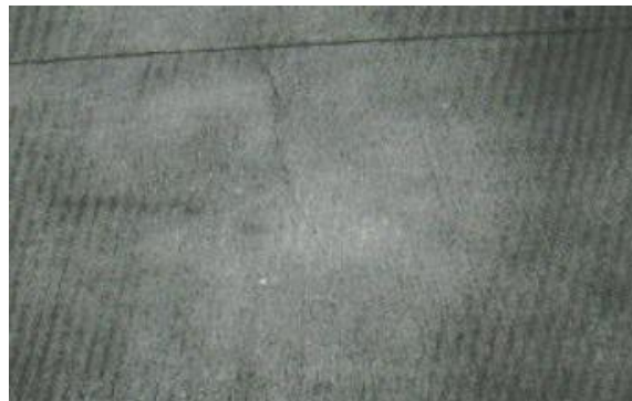
Figura 26. Grietas de contracción
