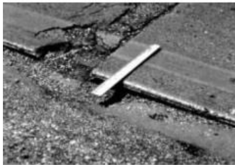
Figura 16. Desnivel carril / Berma de baja severidad
