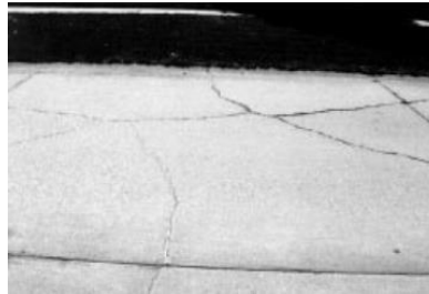
Figura 12. Losa dividida de mediana severidad
