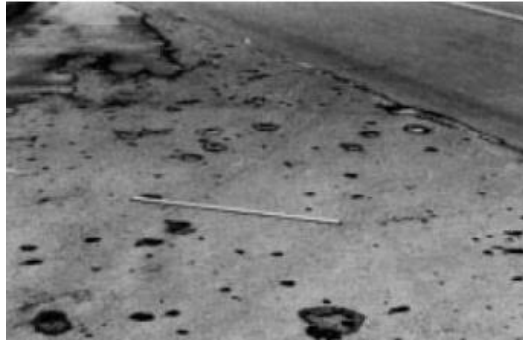
Figura 21. Desprendimientos por disgregación de áridos
