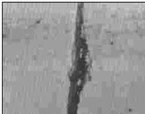
Figura 9. Daño de Sello de Junta de Severidad Media.
