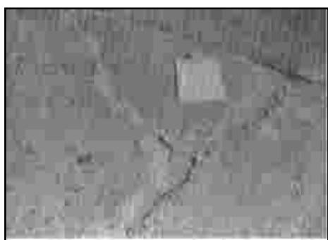
Figura 5. Grieta de Esquina de Severidad Media.
