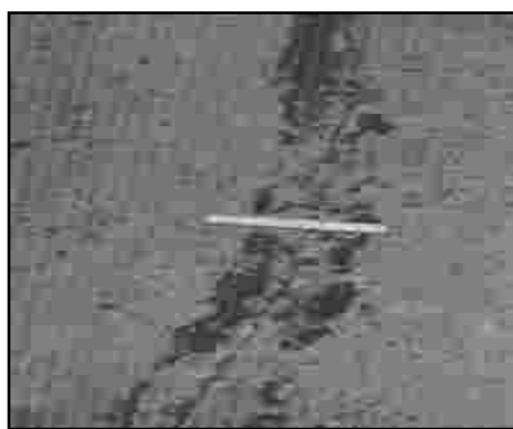
Figura 11. Grietas lineales de baja severidad en losa de concreto simple.
