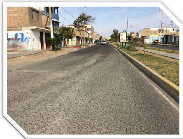
FISURAS LONGITUDINALES Y TRANSVERSALES
