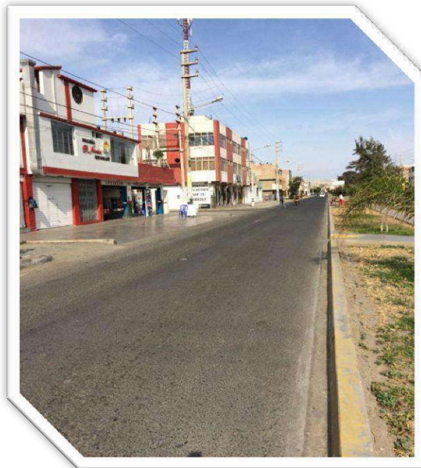
DESCOLORACION DEL PAVIMENTO
