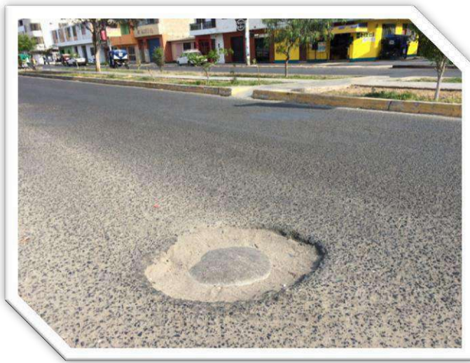
AHUELLAMIENTO Y HUNDIMIENTO
