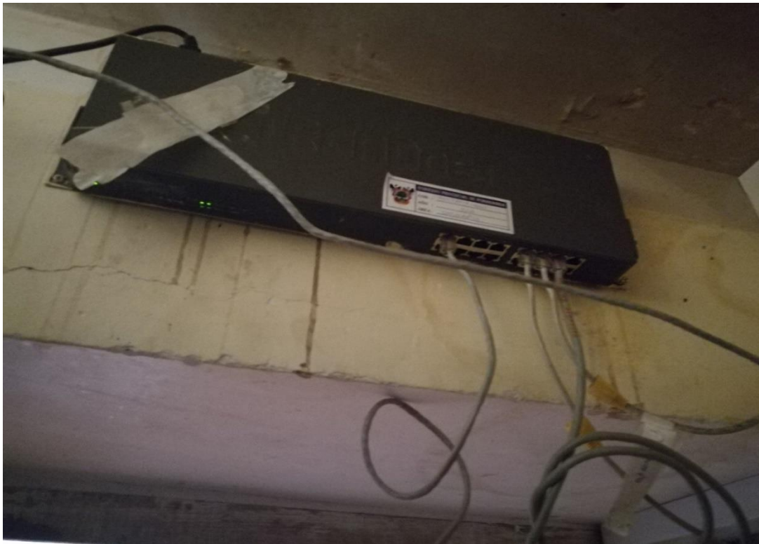
switch principal en el local 01
