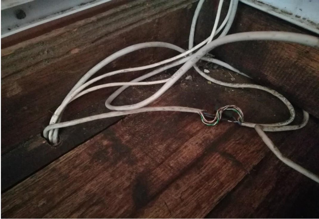
Conexiones en mal estado
