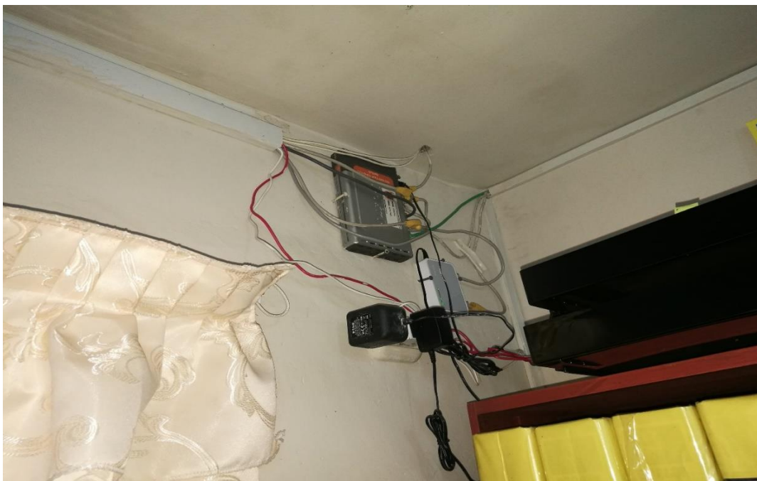
Switch de 8 puertos en la oficina de gerencia de administración
