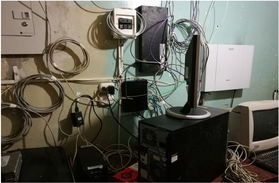
Área de equipos de red en el local 02
