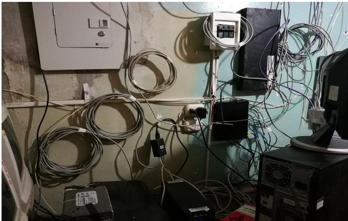
Área de equipos de red en el local 02
