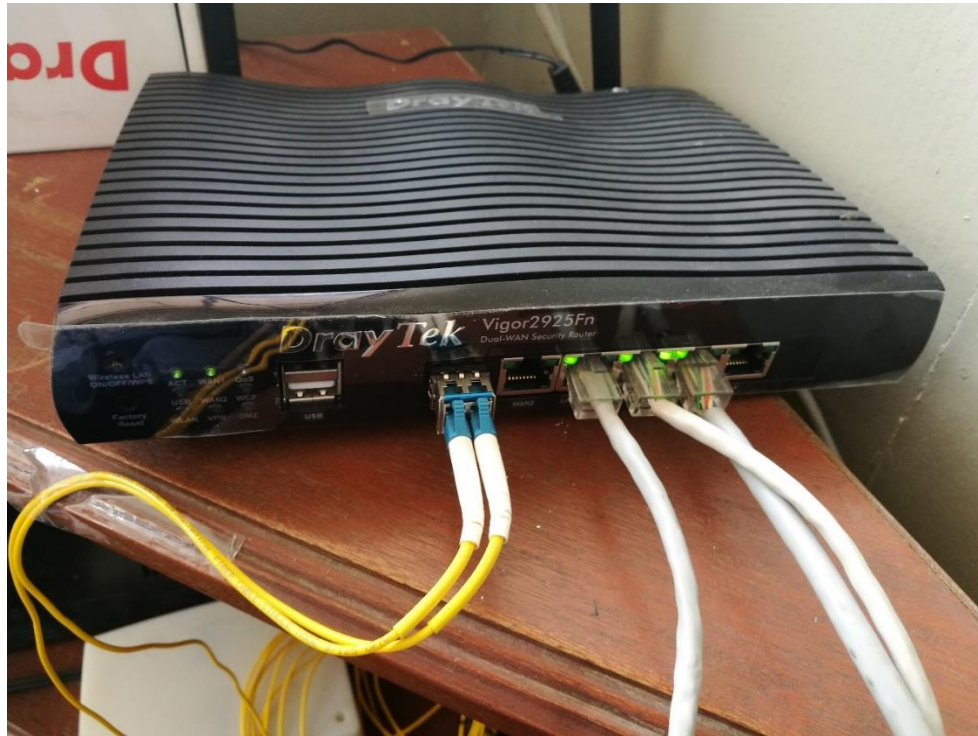
Modem Router principal con conexión de fibra óptica en la oficina de secretaria general
