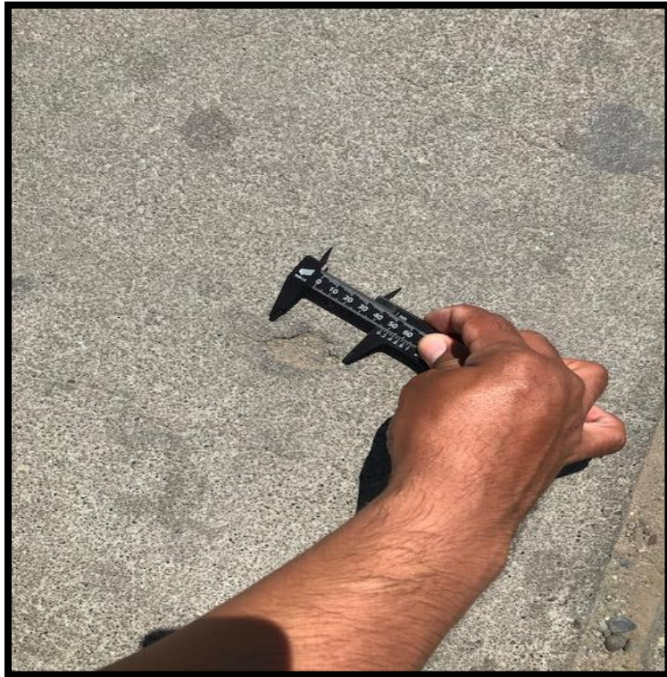
Figura 12: midiendo los vacíos en el pavimento
