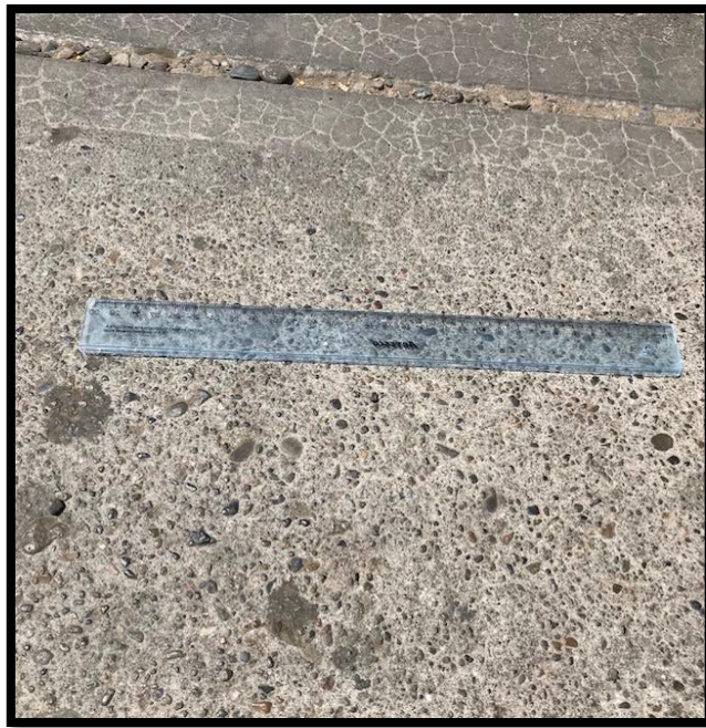
Figura 10: Midiendo la piel de cocodrilo de pavimento
