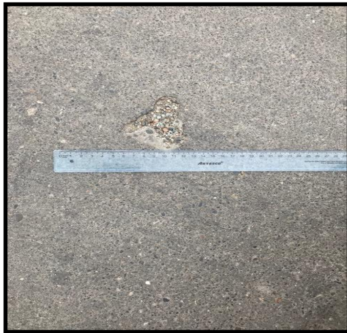
Figura 19: Midiendo los vacíos en el pavimento
