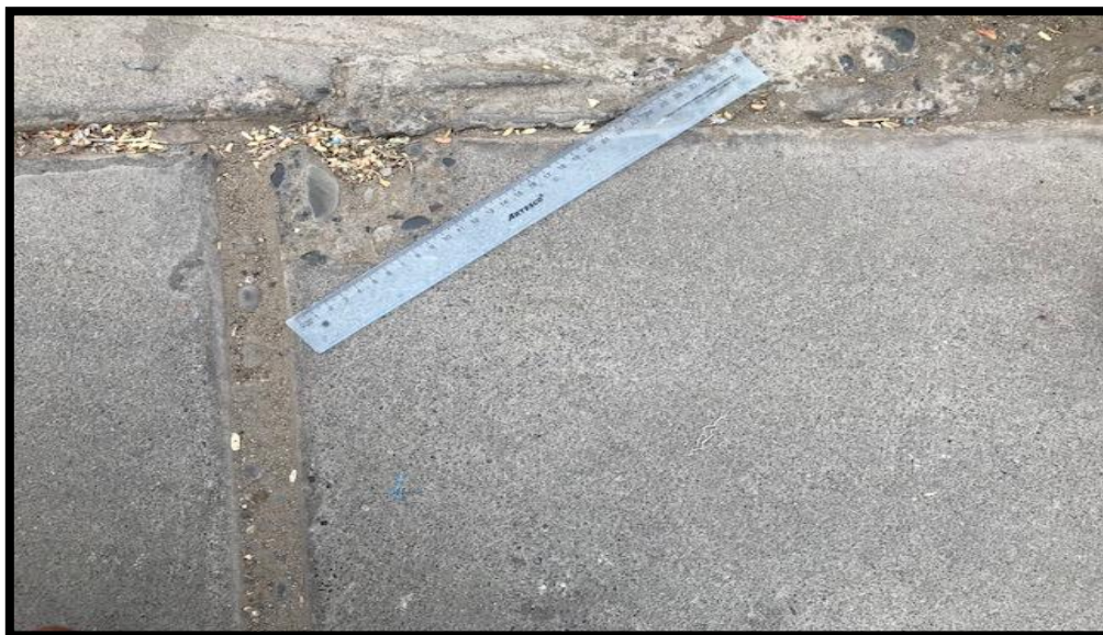
Figura 15: Midiendo la intersección de las juntas.
