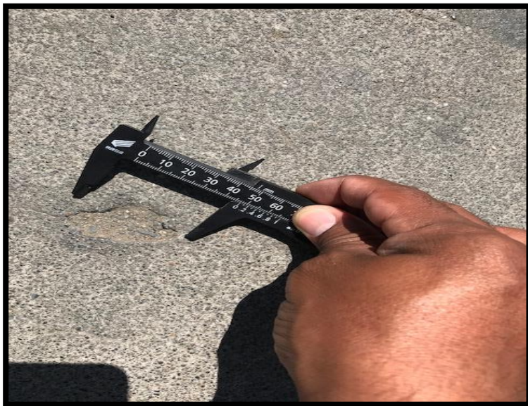
Figura 13: midiendo los vacíos en el pavimento
