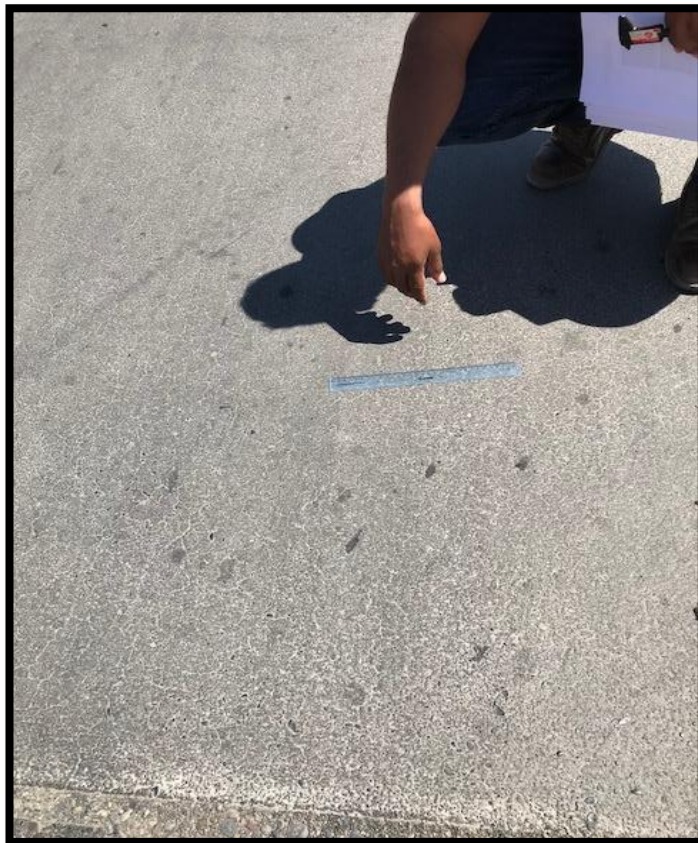
Figura 14: Midiendo la piel de cocodrilo en el pavimento
