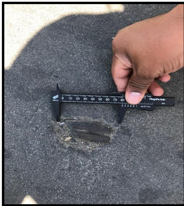
Figura 11: midiendo los vacíos en el pavimento.
