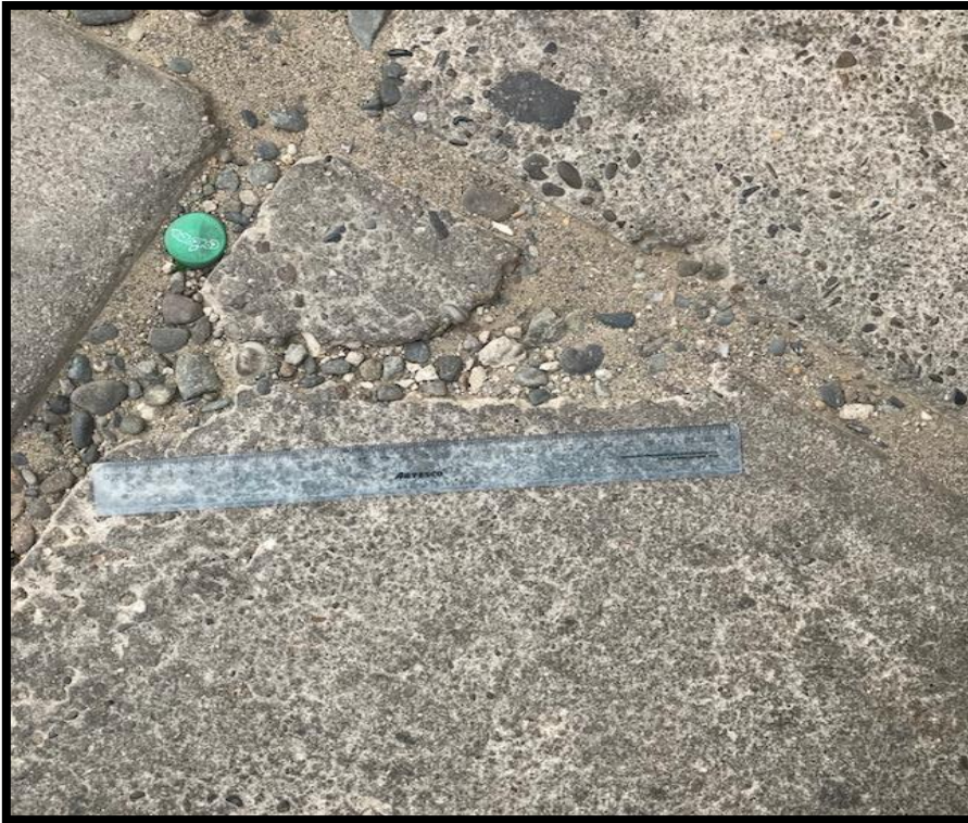
Figura 16: intersección de juntas y fisura miento en la esquina
