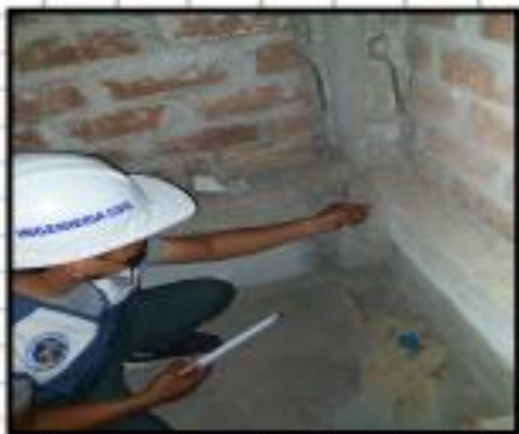
PRESENCIA DE CANGREJERAS EN LA UNION COLUMNA - VIGA
