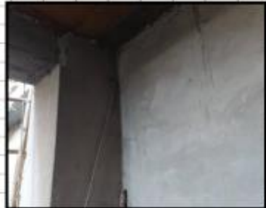
EXCESO DE REVESTIMIENTO EN LAS COLUMNAS - ACABADO MUY ANCHO
