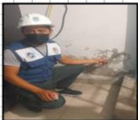
SALITRE EN LAS PAREDES PRODUCTO DE LA HUMEDAD DE LA ZONA
