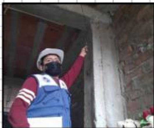
MALA CONEXION ENTRE COLUMNA Y VIGA
