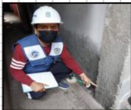
MALA COMPACTACION EN EL VACIADO DE LOS ELEMENTOS
