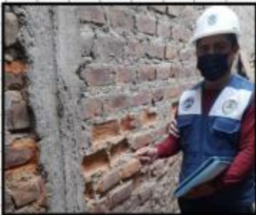
MUROS DE LA PARTE ULTIMA DE LA CASA EN MAL ESTADO - SALITRES EN LADRILLOS
