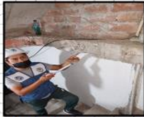
MAL RECUBRIMIENTO - SE NOTA EL ACERO LONGITUDINAL DE LA
