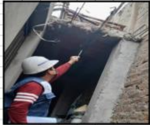
ACEROS SIN PROTECCION EXPUESTOS AL INTERPERIE - FIERROS OXIDADOS
