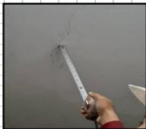
PRESENCIA DE FISURAS EN CIELO RASO EN VARIOS AMBIENTES DE LA CASA
