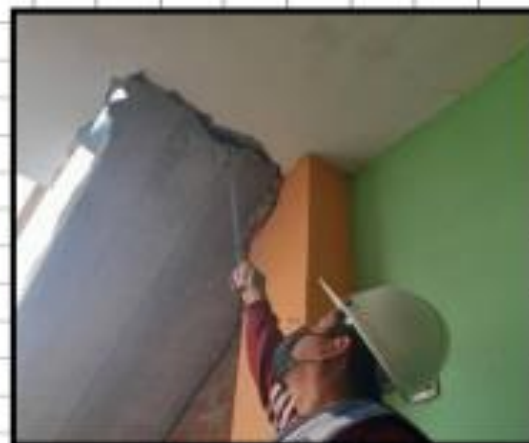
MALA CONECCION DE LA ESCALERA CON LA VIGA CHATA - GRIETA DE GRAN
