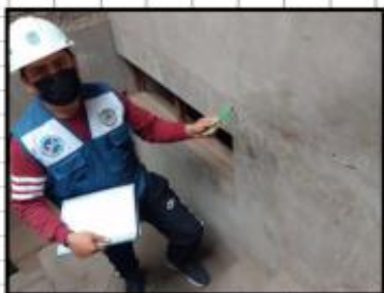
GRIETAS EN LOS MUROS PRODUCTO DE LOS SISMOS
