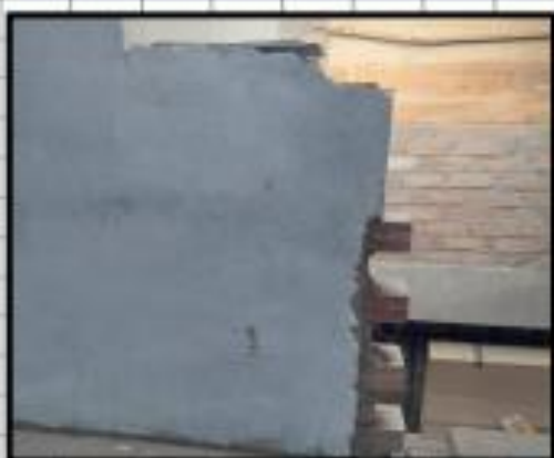
MUROS SIN COLUMNETAS DE CONFINAMIENTO EN SUS XTREMOS
