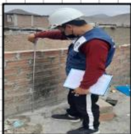
ALTURA DEL PARAPETO EN LA AZOTEA DE 1.00 M
