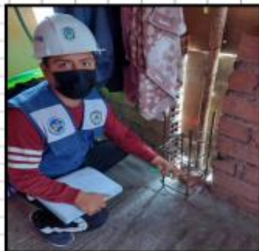
ACERO CON PRESENCIA DE OXIDOS - NO SE PROTEGIERON - ESTAN EXPUESTOS AL AIRE LIBRE
