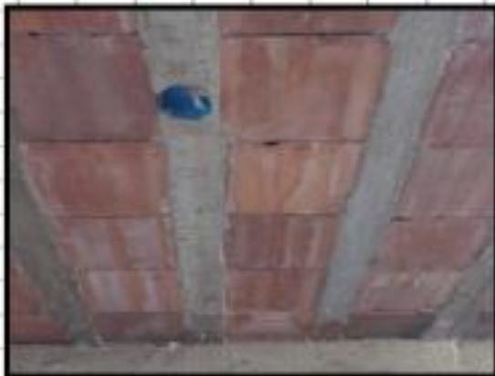
OCTAGONALES O CAJAS DE LUZ UBICADOS EN LA VIGUETAS
