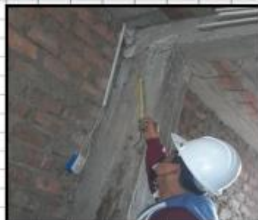
GRIETAS EN LAS UNIONES DE COLUMNAS Y VIGAS
