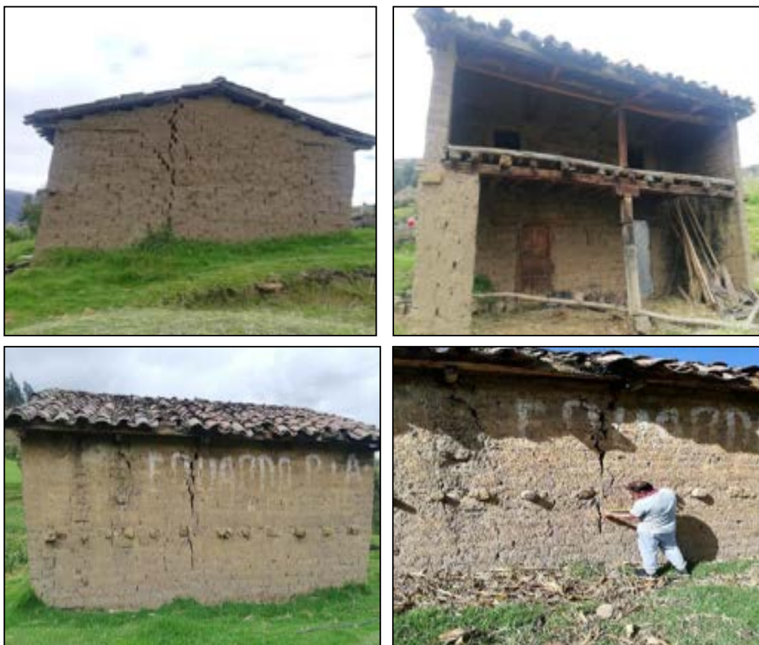
Figura 16. Algunas de las patologías más resaltantes en la vivienda N° 1.
