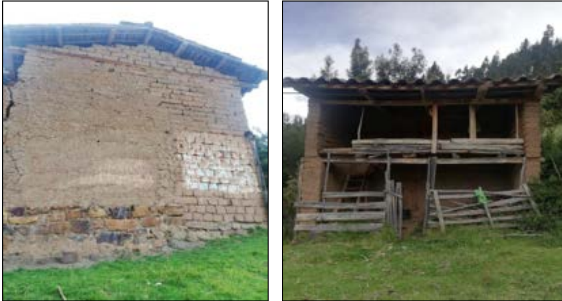
Figura 20. Algunas de las patologías más resaltantes en la vivienda N° 3.
