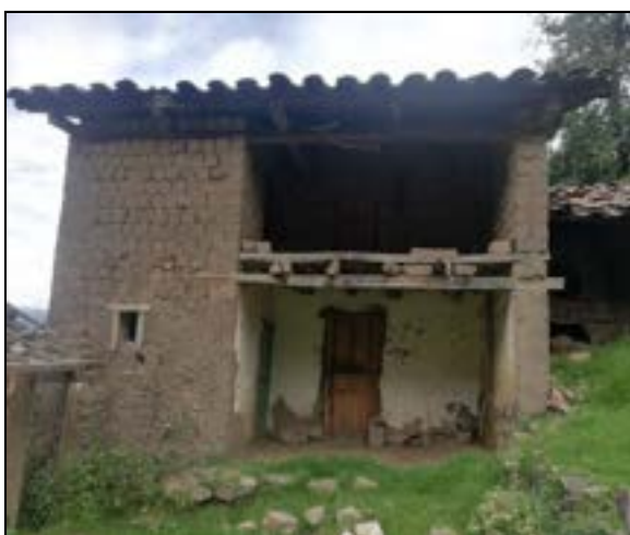
Figura 18. Algunas de las patologías más resaltantes en la vivienda N° 2.
