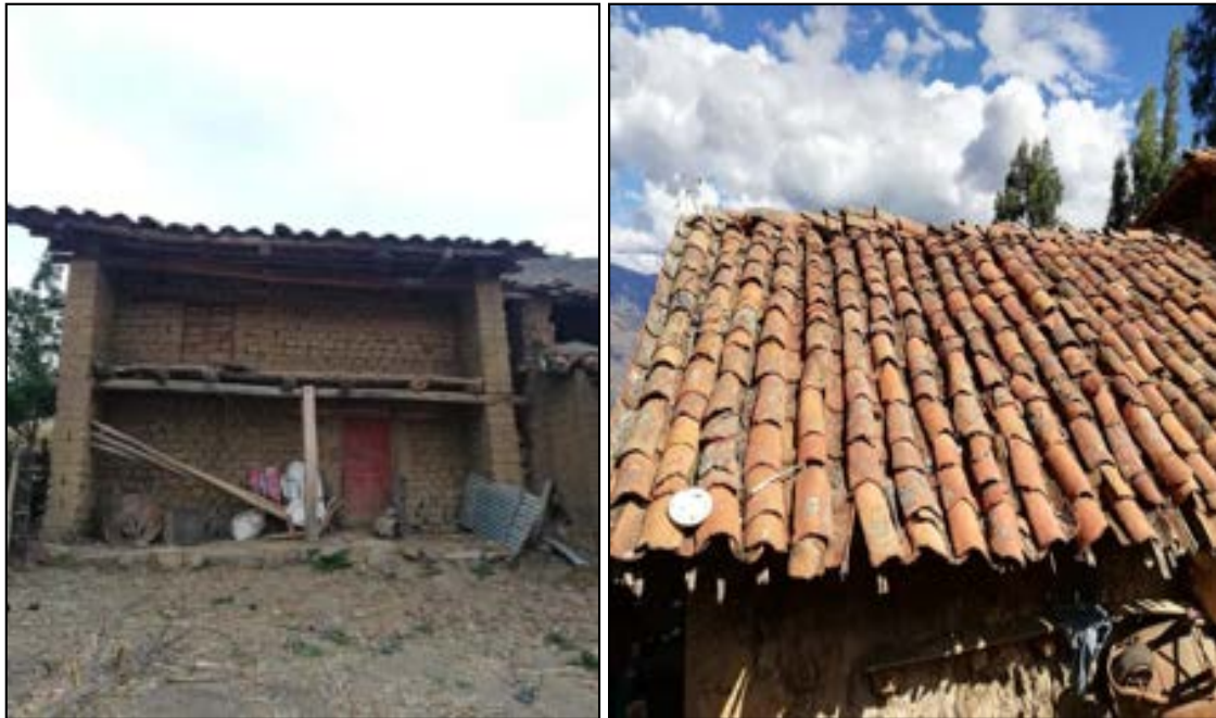
Figura 24. Algunas de las patologías más resaltantes en la vivienda N° 5.
