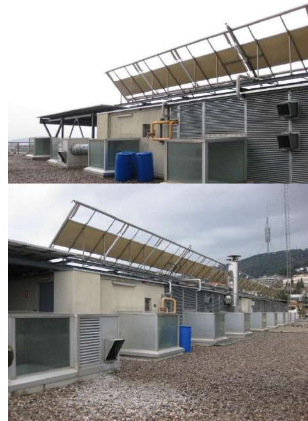
Figura 54. Calentadores solares para el agua caliente. Recuperado de: http://www.terradasarquitectos.com/es/proyectos/Aulario-LS
