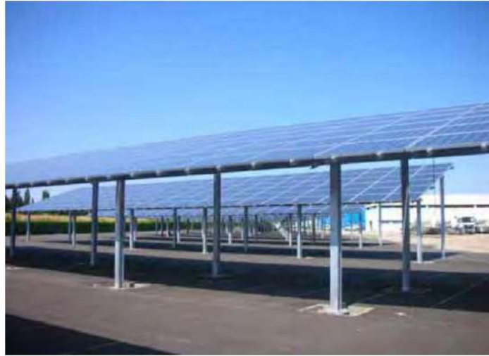
Figura 95. Instalación sobre mobiliario urbano. Recuperado de: http://www.madrid.org/bvirtual/BVCM005913.pdf
