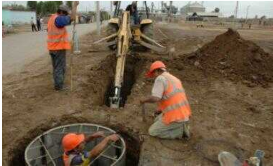
Figura 19: Almacenamiento Agua potable/ EPS Chavín
