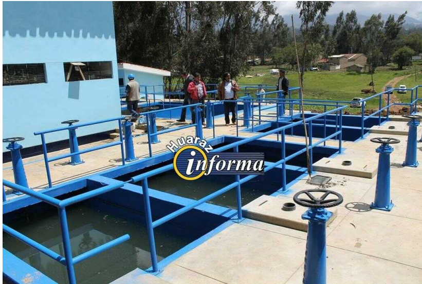
Figura 18: Almacenamiento Agua potable/ EPS Chavín
