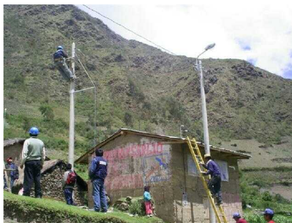
Figura 17: Postes de Energía Eléctrica
