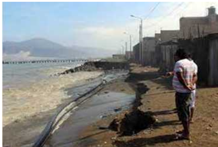
Figura 7: Erosión Costera y Vulnerabilidad Urbana
