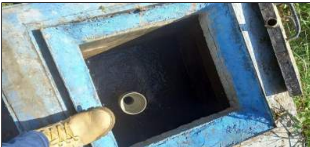
Fotografía 14. Interior de la Cámara Húmeda. Fuente: Propia.
