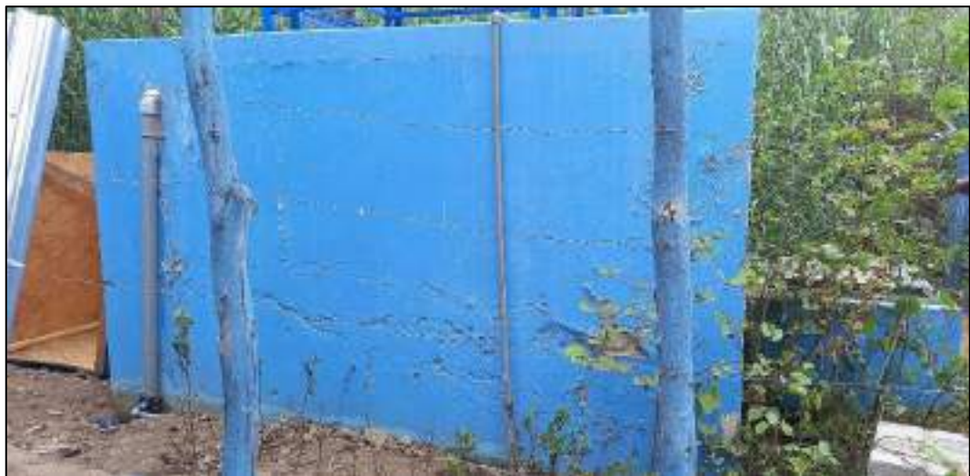
Fotografía 6. Fotografía del estado del Cerco Perimétrico. Fuente: Propia
