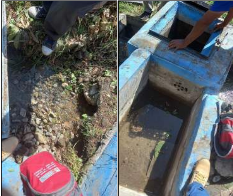
Fotografía 11. Zona de Afloramiento con Modificaciones hechas por la población. Fuente: Propia.
