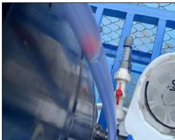
Fotografía 9. Medidor de Agua del tanque Principal. Fuente: Propia.
