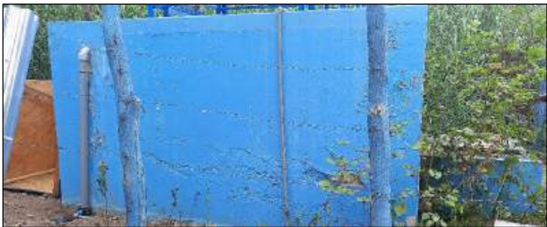
Fotografía 2. Agrietamiento de las Paredes del Reservorio. Fuente: Propia.
