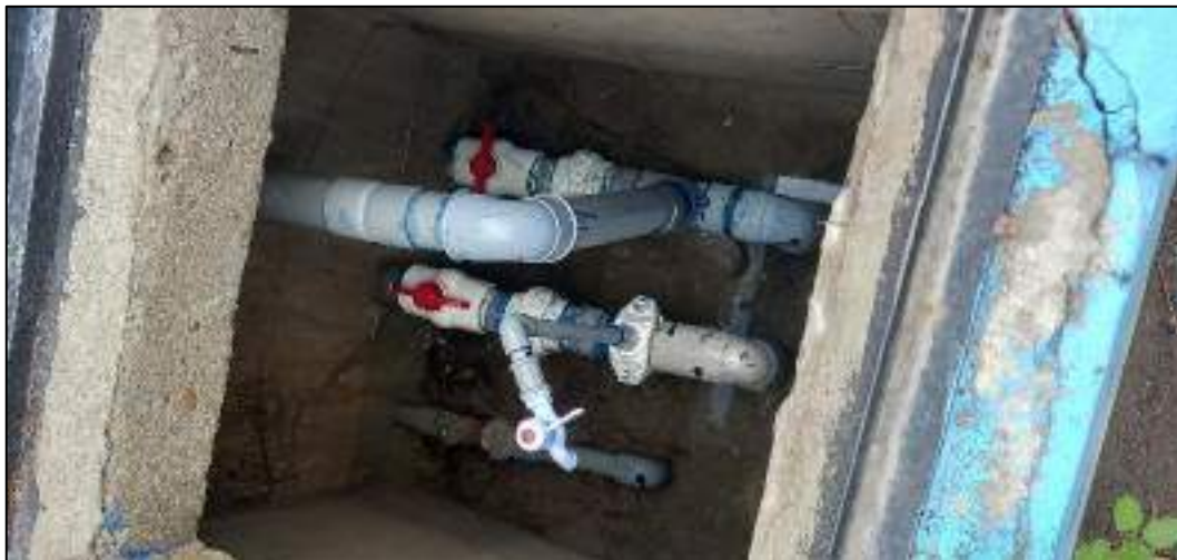
Fotografía 7. Interior inundado de la caja de válvulas. Fuente: Propia.
