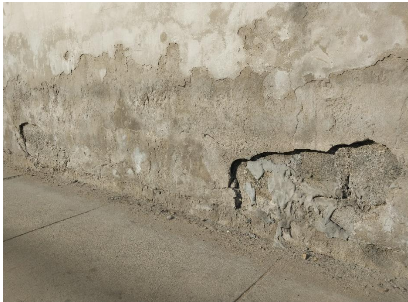
Figura N°3: Descascaramiento del muro en la parte inferior
