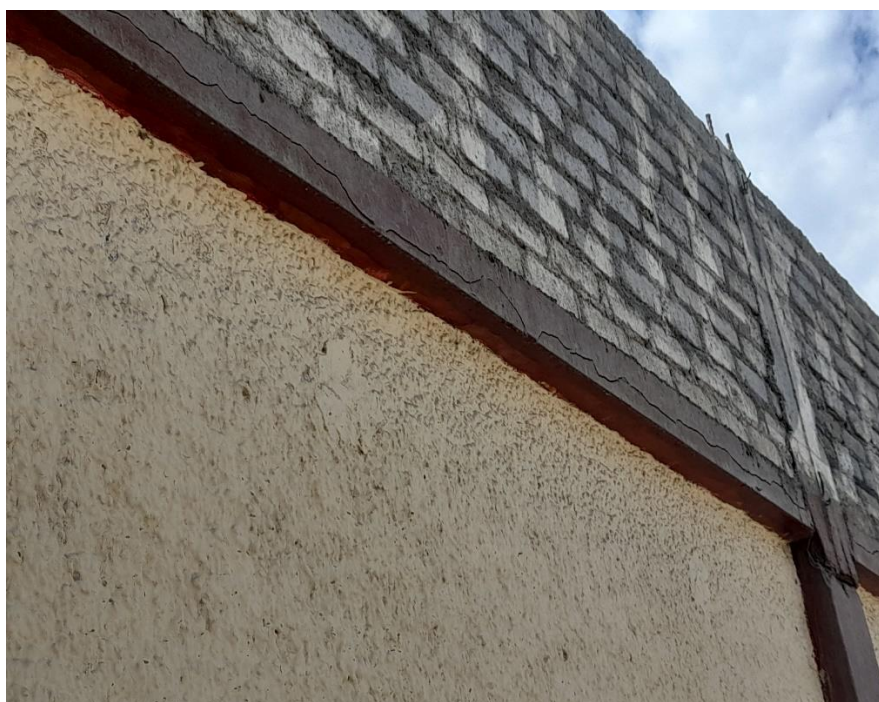
Figura N°12: Grieta horizontal en la viga
