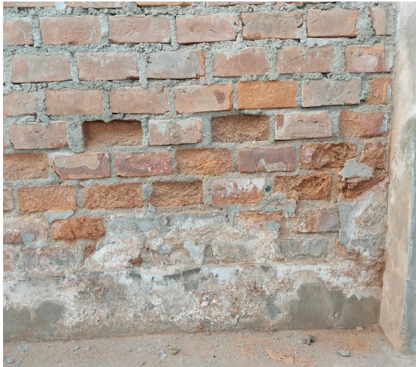
Figura N°1: Erosión del muro en la parte inferior
