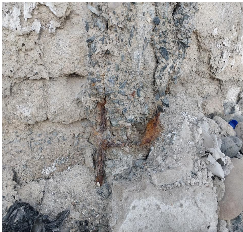
Figura N°2: Corrosión del muro en la columna de la parte inferior
