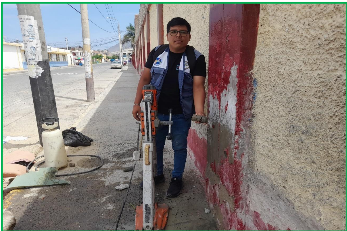
Se extrajo el testigo correspondiente con una perforadora diamantina del muro perimetral 2
