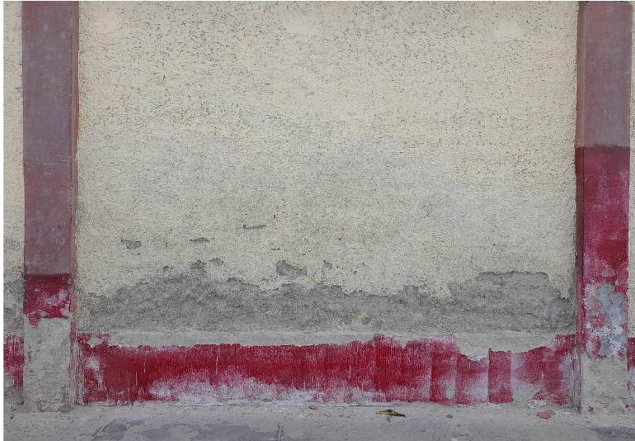
Figura N°4: Eflorescencia del muro en la parte inferior
