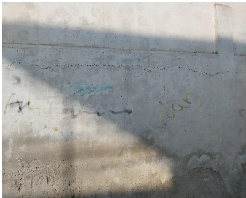
Figura N°8: Fisuración del muro en la parte superior
