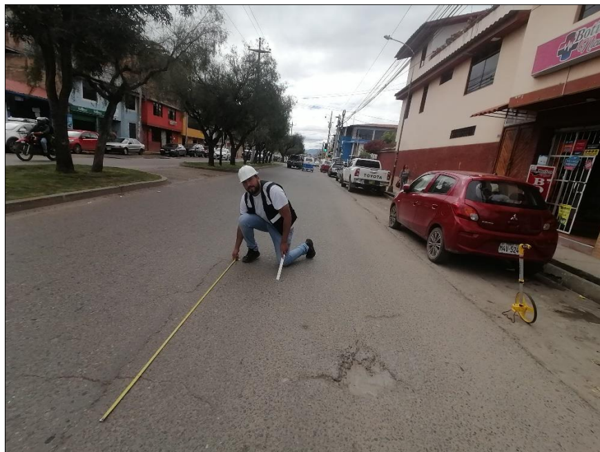
Fotografía 12 Medición de patología grieta longitudinal, severidad baja. Av. Mario Urteaga, sentido SE – NO.
