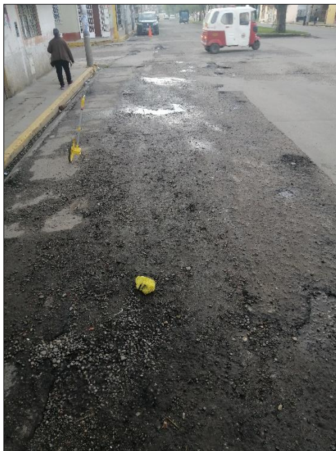
Fotografía 13 Patología desprendimiento de agregados, severidad alta. Av. Mario Urteaga, sentido SE – NO.
