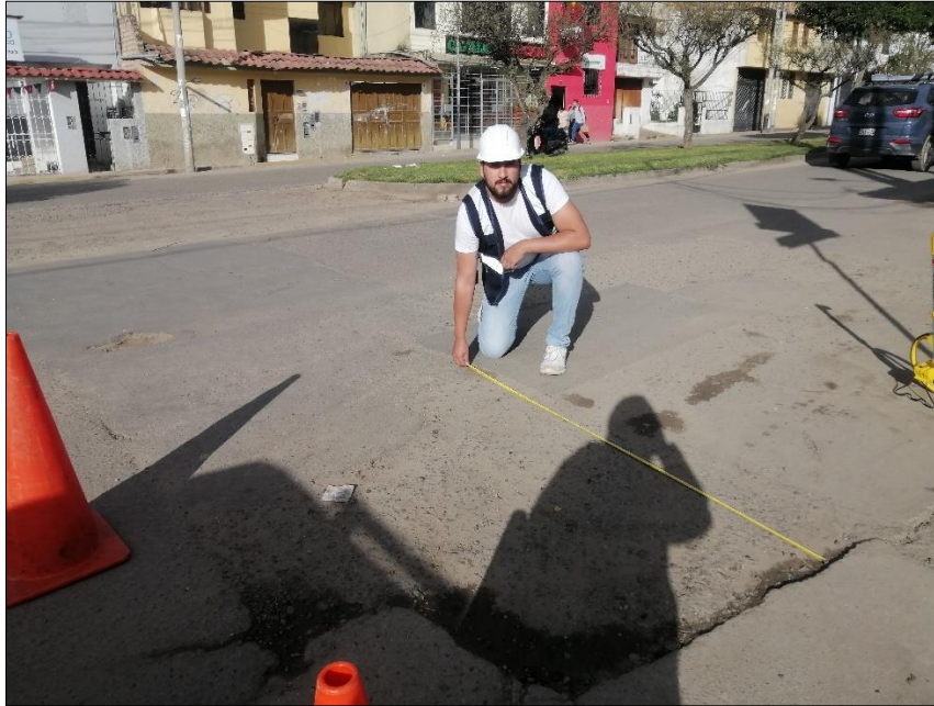
Fotografía 11 Medición de patología desprendimiento de agregado, severidad alta. Av. Mario Urteaga, sentido SE – NO.
