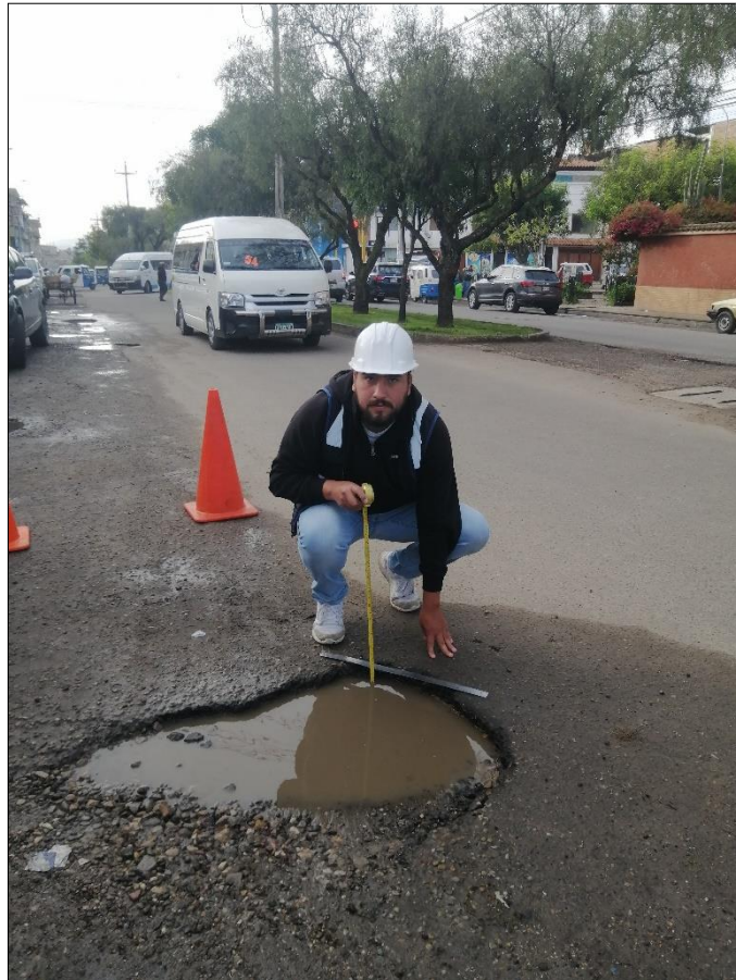
Fotografía 15 Medición de patología hueco, severidad alta. Av. Mario Urteaga, sentido SE – NO.
