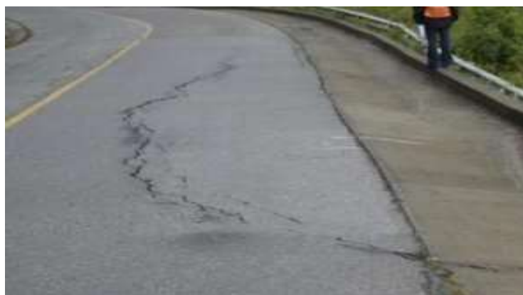
Figura 14. Fisura de Borde
