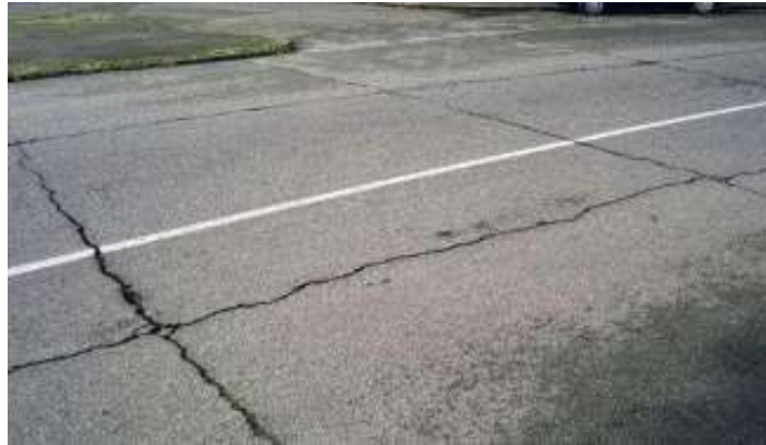
Figura 13. Fisuras de Borde
