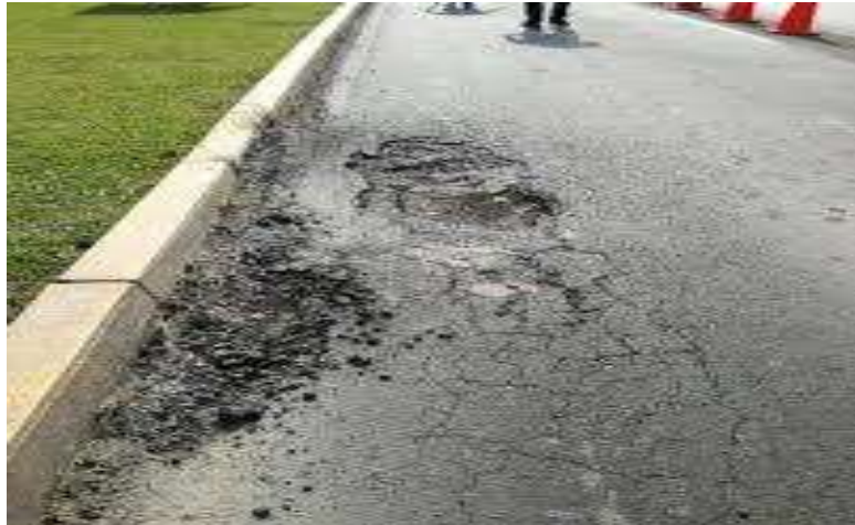
Figura 10. Abultamientos y hundimientos
