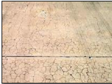
Figura 11: Desprendimiento superficial, mapa de fisuras, fisuras erráticas
