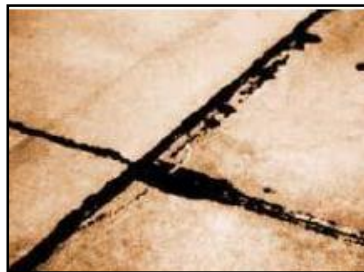
Figura 16: Desprendimiento en la Esquina
