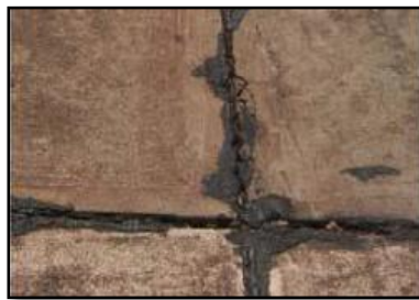
Figura 15: Desprendimiento (en Juntas Longitudinales y Transversales)
