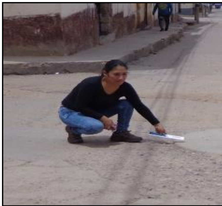
Figura 01: Evaluación de fallas en el Jr. San Martin
