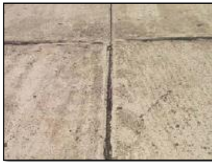
Figura 07: Daño del Sellado de Juntas
