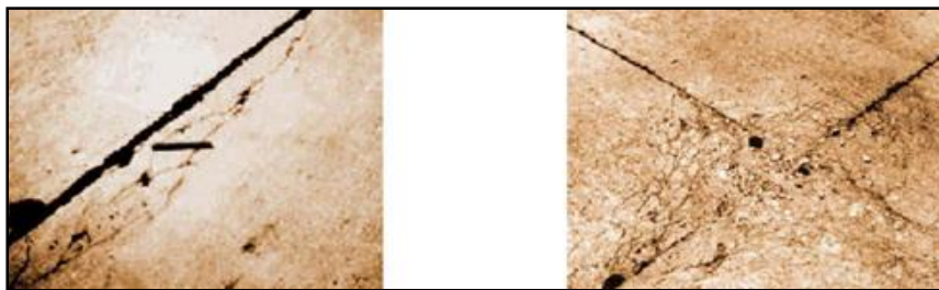
Figura 06: Fisuras de Durabilidad
