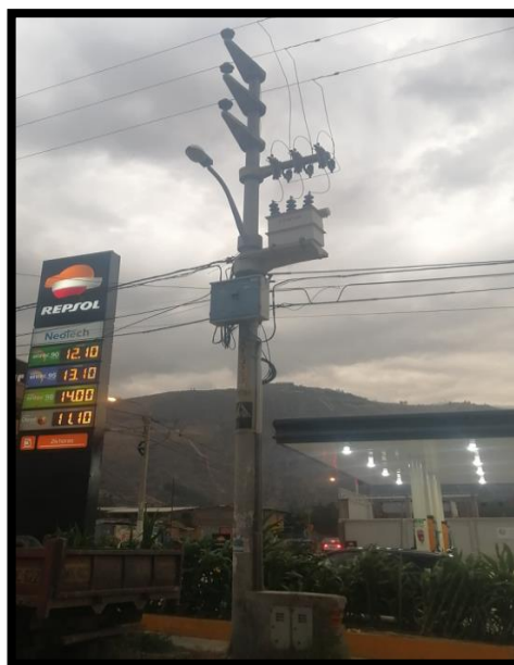
Figura 3: Transformador de 75KVA existente, estructura monoposte
