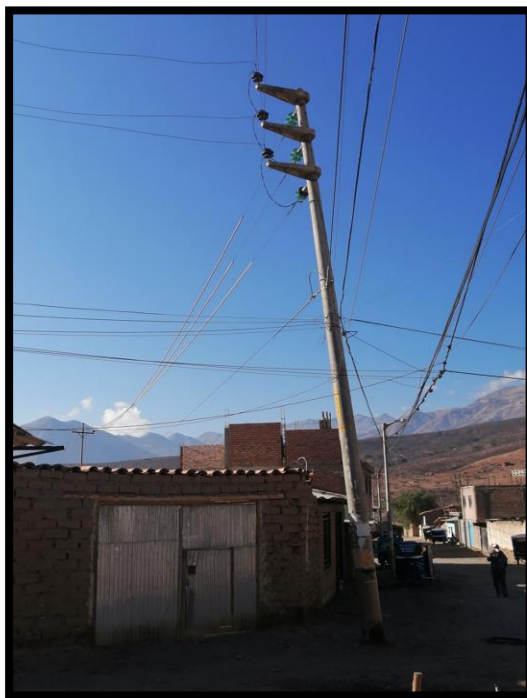
Figura 4: Estructura en mal estado a punto de caerse
