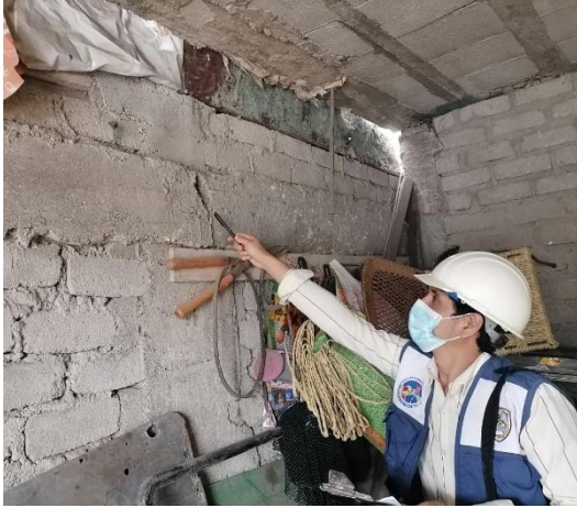
FOTO N°21 Evaluación de las fallas en la columna de la vivienda localizada en Jr.Fray martín Y1 – Lt9
