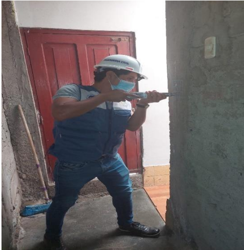
FOTO N°9: Aplicación de la esclerometría en la columna de la casa localizada en Jr. Independencia Mz I2-Lt27.
