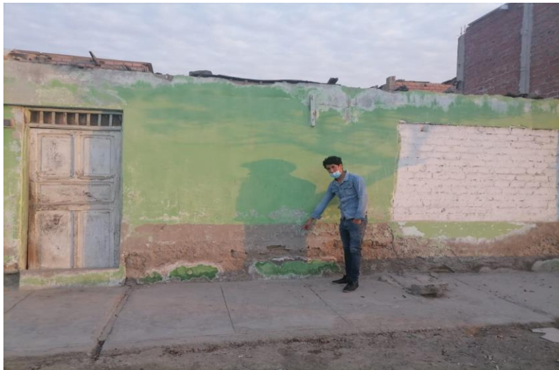
FOTO N°23: Evaluación de las deficiencias en la vivienda Jr. Independencia Mz I2 – Lt 27.
