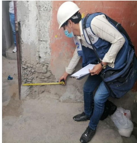
FOTO N°10: Deficiencias en la casa Jr. Leoncio Prado Mz D2 – Lt 12 , donde se observó segregación de los agregados finos y grueso.
