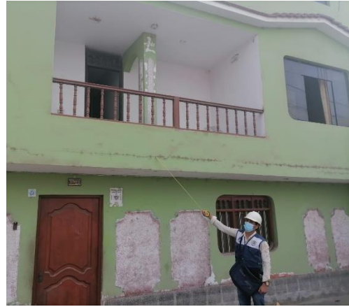
FOTO N°22: Paredes de albañilería con fisuras en la vivienda Jr. Independencia Mz H2 – Lt40
