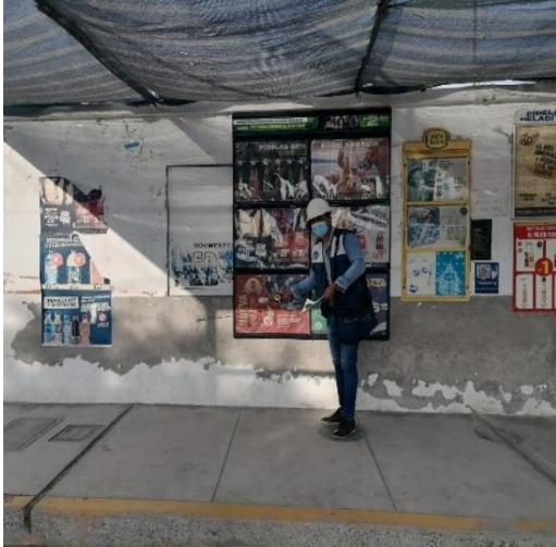
FOTO N°11: Deficiencias en la casa Jr. JR. Leoncio Prado Mz H2 – Lt 25, Entre ellos, el uso de materiales de baja calidad y el deterioro del mortero.
