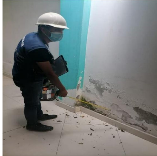
FOTO N°14: Paredes con presencia de eflorescencias en la casa localizada en Jr. Pasco Mz U1- Lt 1
