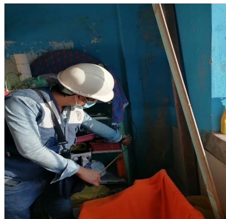
FOTO N°20: Evaluación de las fallas en la columna de la casa localizada en Jr. Ladislao Espinar Mz F2 – Lt 34
