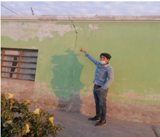
FOTO N°15: Grietas en el muro en la vivienda localizada en Psj: Fátima C2 – Lt 6
