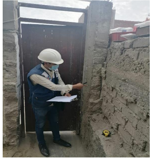
FOTO N°18: Grietas en el muro en la vivienda localizada en Psj: Fátima C2 – Lt 6
