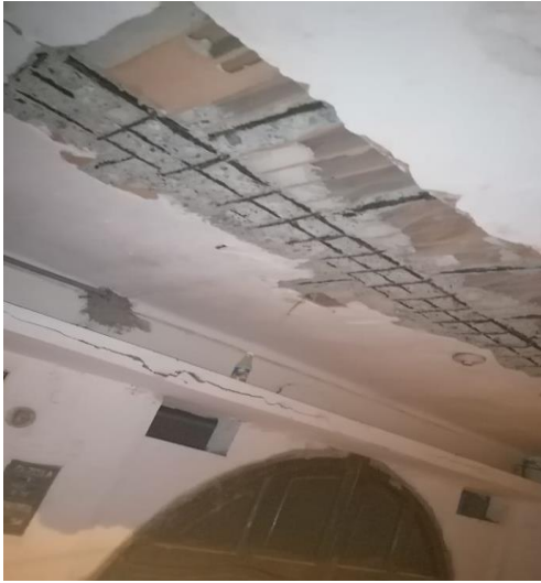
FOTO N°17: Acero expuesto a corrosión en la vivienda Jr. 9 de octubre Mz Q1 – Lt 8
