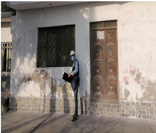
FOTO N°19: Paredes de albañilería expuesto a la humedad en Jr. Pasco Mz Q1 – Lt 19.
