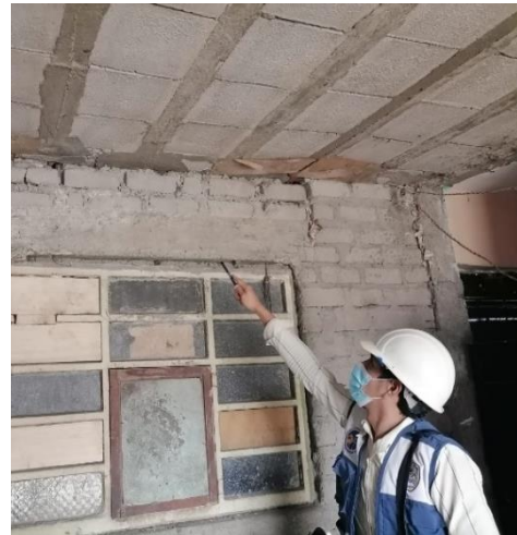
FOTO N°12: Falta de confinamiento al muro tales como viga en la vivienda Jr. Ladislao Espinar Mz F2 – Lt 28.
