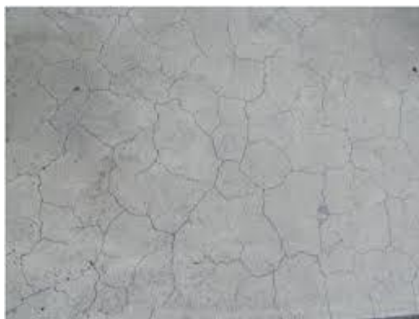
Figura 10. Fisuras en mapa
