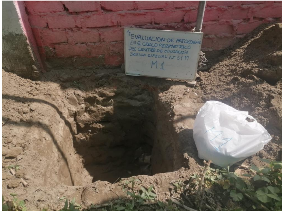
Figura 107. Evaluación de patología en el cerco perimétrico del Centro de Educación Básica Especial M1.
