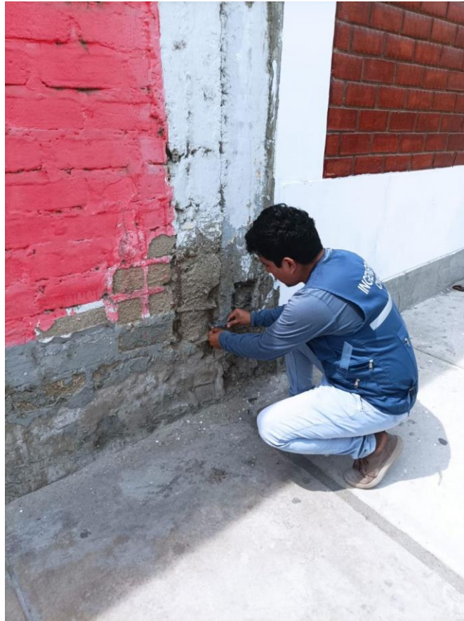
Figura 86. Medición con el calibrador del diámetro del acero expuesto de las columnas del cerco perimétrico – frente 4.
