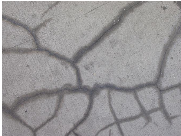
Figura 9. Fisuras por retracción plástica
