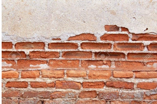
Figura 8. Erosión en muro
