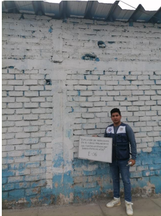
Figura 96. Muestra de la columna E-06 – frente 3, para el ensayo de esclerometría
