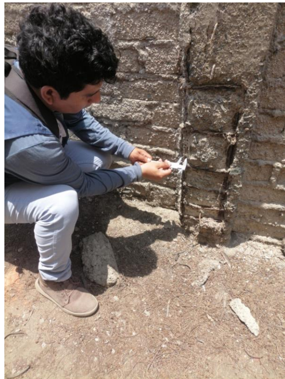
Figura 85. Medición con el calibrador del diámetro del acero expuesto de las columnas del cerco perimétrico – tramo 1.
