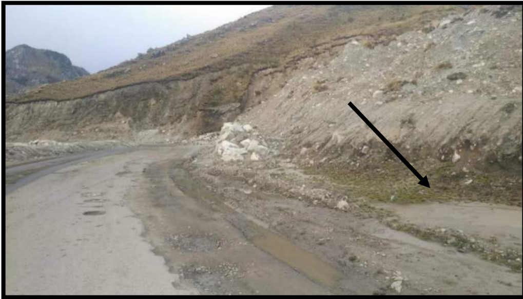
Anexo 11: el punto más crítico del lugar se sitúa en las coordenadas; E: 245800.411, N: 8954647.059, H:4174.61.
