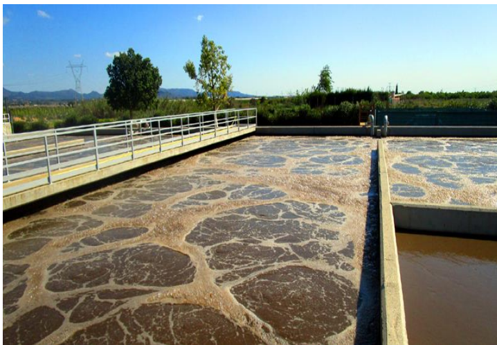
Figura 20. Tratamiento Secundaria de Aguas Residuales, Nuevo,( 2023)
