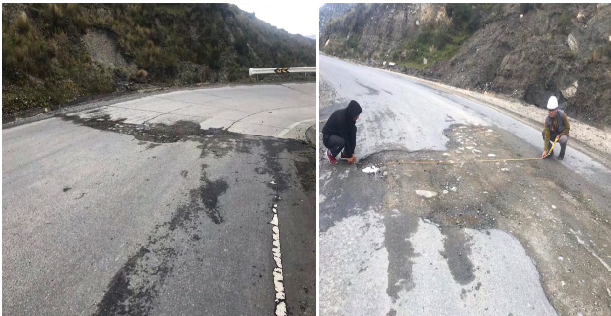
Figura 24. Fisuras transversales y longitudinales.
