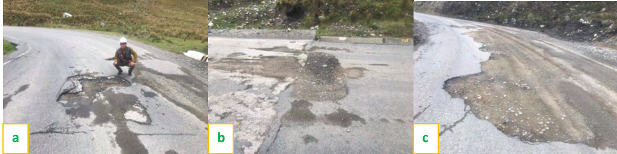
Figura 6. Fisuras Longitudinales Y Transversales, Nivel De Severidad Bajo (a), Medio (b) y Alto (c). (Fuente: Rodríguez, 2009).
