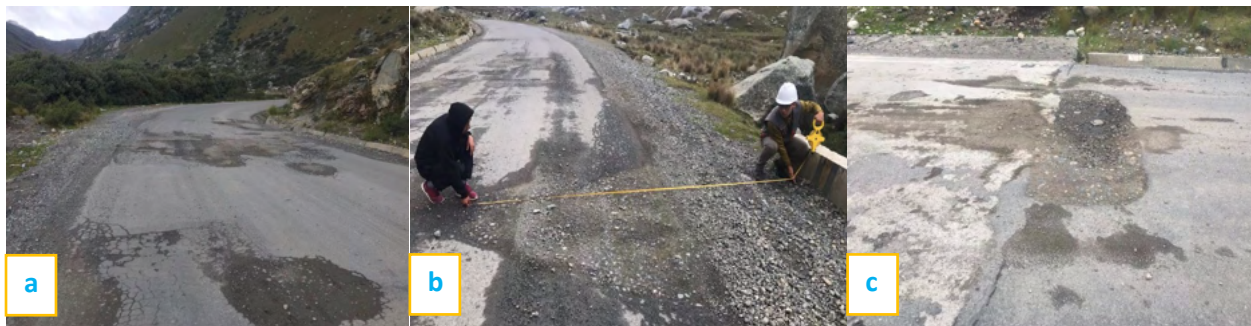
Figura 5. Agrietamiento de bordes con tres niveles de gravedad: leve (a), medio (b) y severo (c) (Fuente: Rodríguez, 2009).
