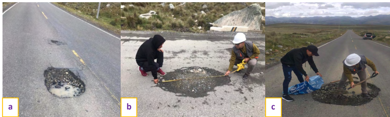
Figura 7. Baches con una severidad de los siguientes niveles, Baja (a), media (b) y alta (c) (Fuente: Rodríguez, 2009).
