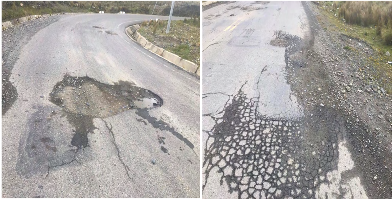
Figura 23. Parche deteriorado de alto nivel de severidad.
