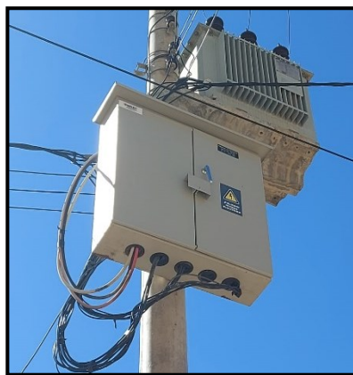
Figura N° 03: Tablero de distribución.
