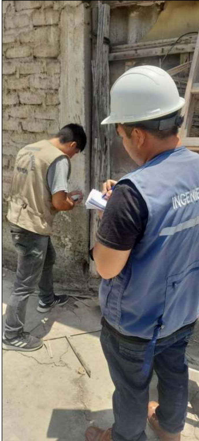
Ensayo de esclerometría en una columna atacada por las sales.
