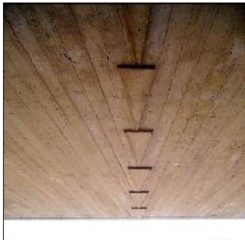
Figura 72: Molduras en cimbra del concreto para enfatizar la visual al centro de los patios.
