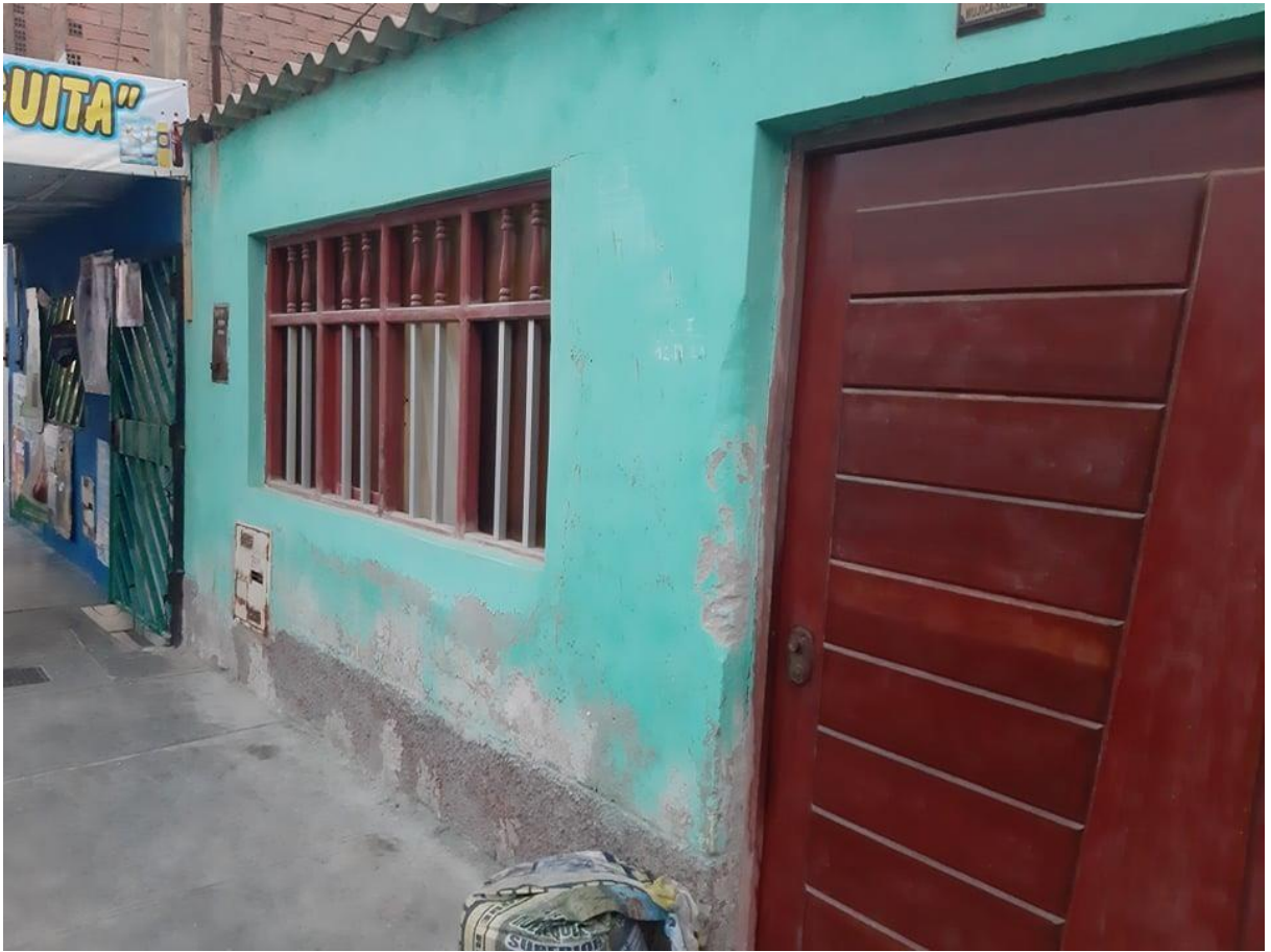
Muros con manchas de eflorescencia.
