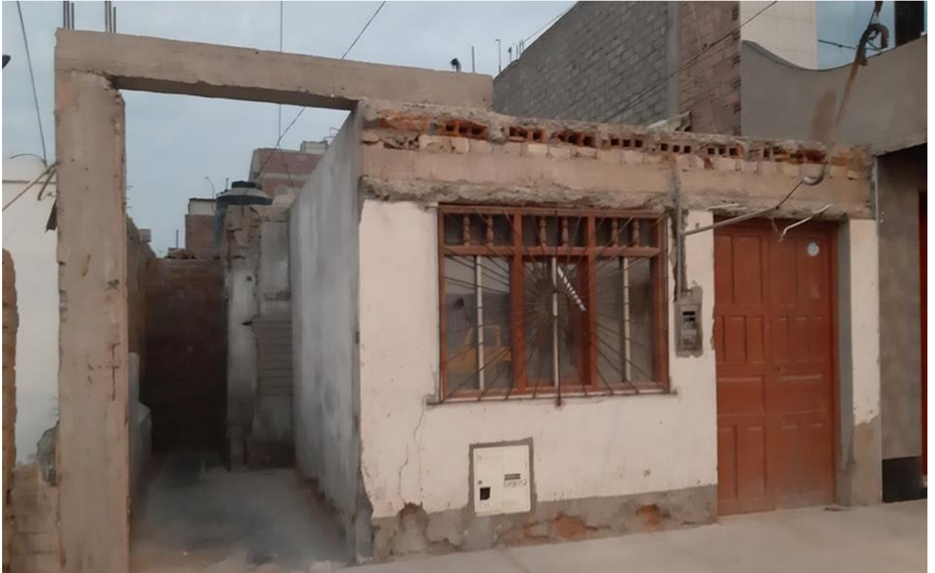
Losa aligerada en mal estado de conservación, agrietamiento en muros exteriores.
