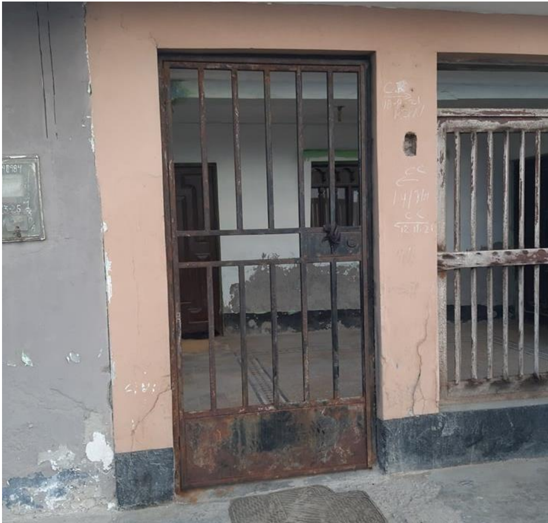
Agrietamientos en columna y alero de fachada.
