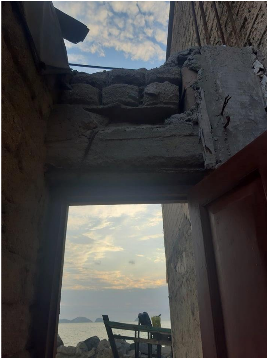
Dinteles de vanos de puertas, en mal estado de conservación y proceso constructivo.
