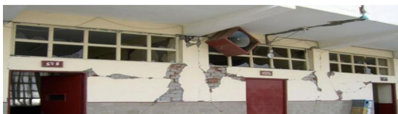
Figura 15: Daños estructurales en el Colegio Humboldt después del terremoto en Pisco en 2007
