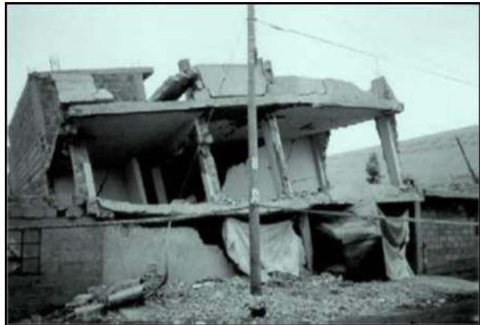
Figura N°07: Error en el confinamiento de muros
