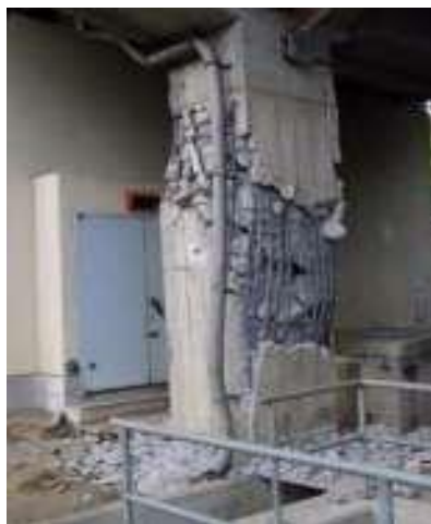
Figura N°04: Falta de estribos - Fallas
