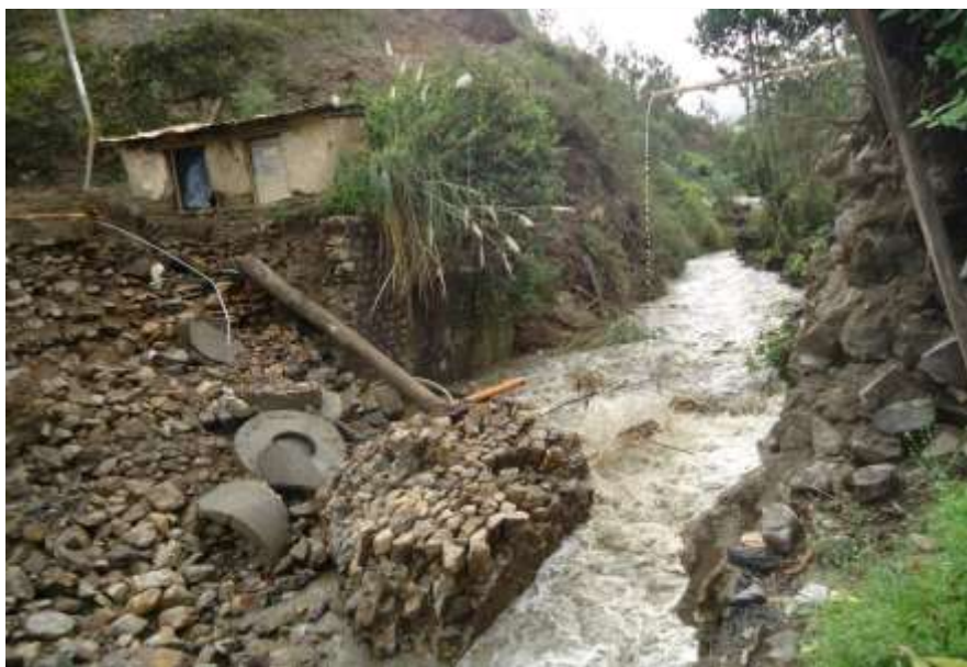
Figura 18: colapso del puente a consecuencias de las fuertes lluvias.
