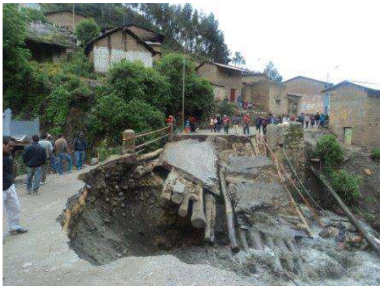
Figura 1: Inundación con aguas pluviales de la localidad de Tarica.
