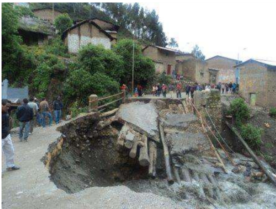
Figura 22: derrumbe del puente.
