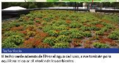
Techo Verde El techo verde además de filtrar el agua calurosa, sirve también para mejorar el aislamiento de los ambientes.
