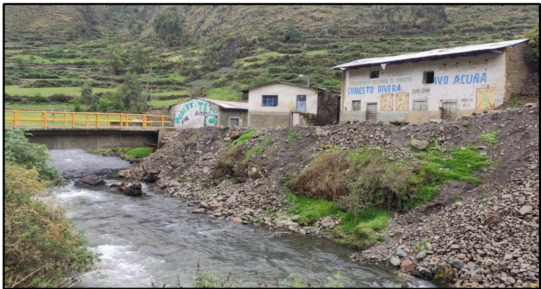
Imagen N° 09: En la imagen se aprecia la falta de muro de contención para la protección de la vivienda que se encuentran al margen del río.
