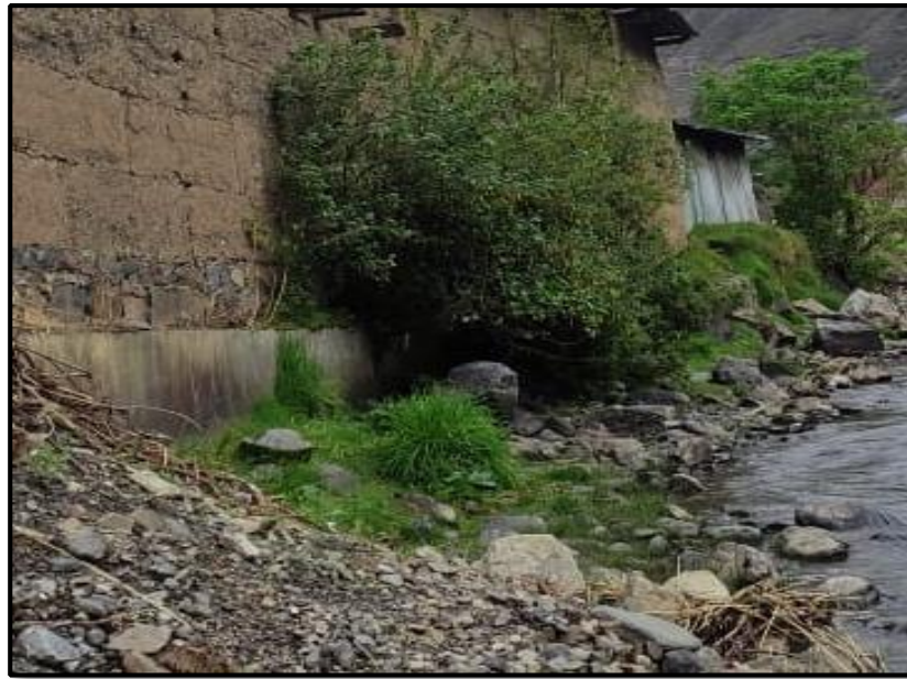
Imagen N° 08: En la imagen se observa los daños que ocasiona el desborde del río a las viviendas.
