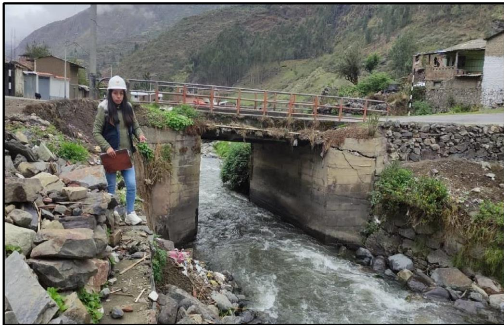
Imagen N° 07: Se observa en esta imagen las deficiencias y grietas que tiene el puente a causa de la crecida del río en época de lluvia. Fuente: Elaboración Propia.
