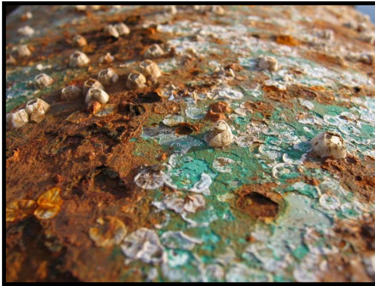
Figura # 8: Corrosión de acero de refuerzo.
