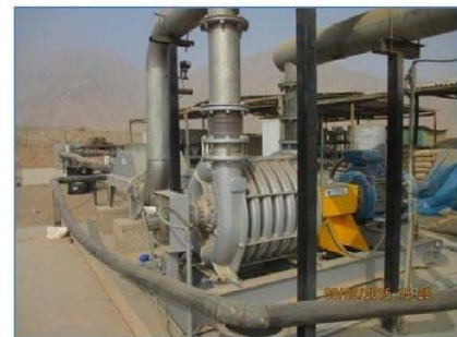
Planta de tratamiento de biogás
