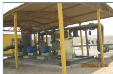
Planta de tratamiento de Biogás
