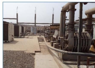
Ampliación de la Estación de Compresión
