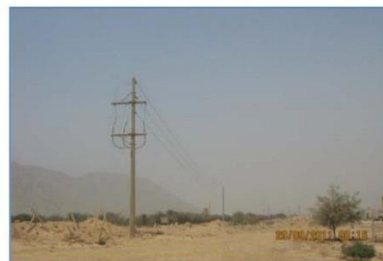
Línea de subtransmisión 22,9 kV
