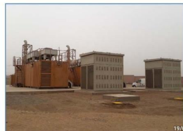
Unidades de Generación y Transformadores
