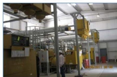
Grupos de Generación 3 x 1,6 MW
