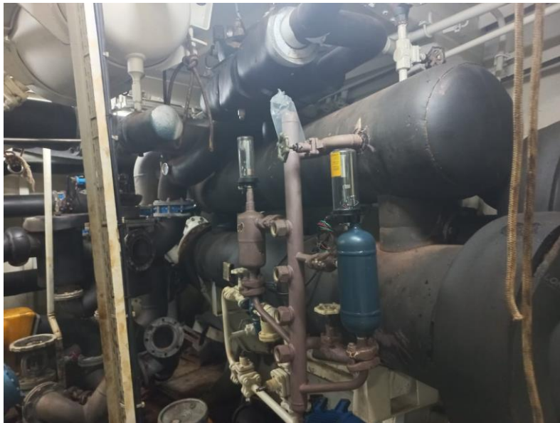
Figura 6. Sistema de refrigeración de la empresa HUMACARE
