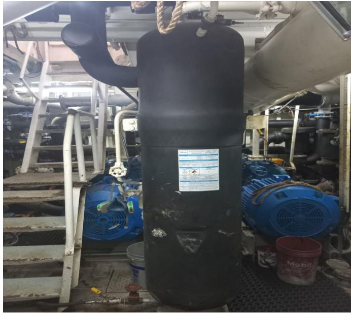
Figura 3. Sistema de refrigeración de la empresa HUMACARE
