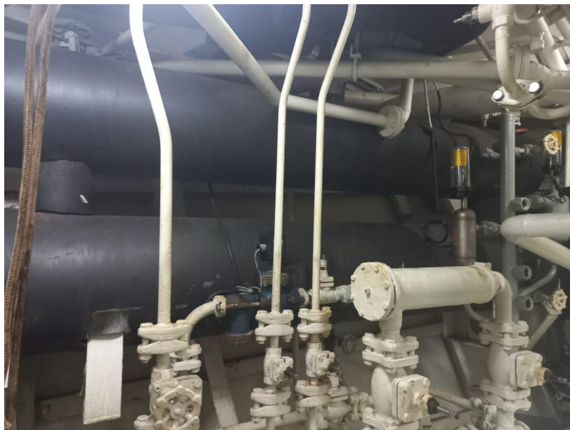
Figura 4. Sistema de refrigeración de la empresa HUMACARE
