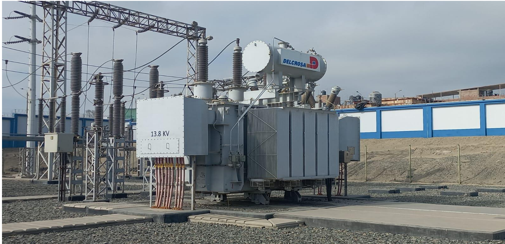
Anexo 16. Transformador del Alimentador CHN025 9na Norte
