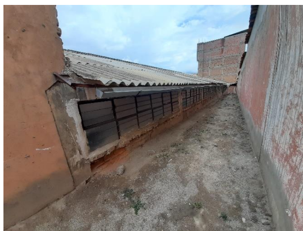
Figura 32. Estado de conservación del pabellón C. Fuente: Elaboración propia
