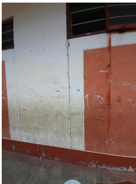
Figura 14. Estado de conservación del pabellón A. Fuente: Elaboración propia
