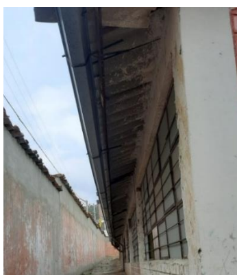
Figura 39. Elementos no estructurales del pabellón D. Fuente: Elaboración propia
