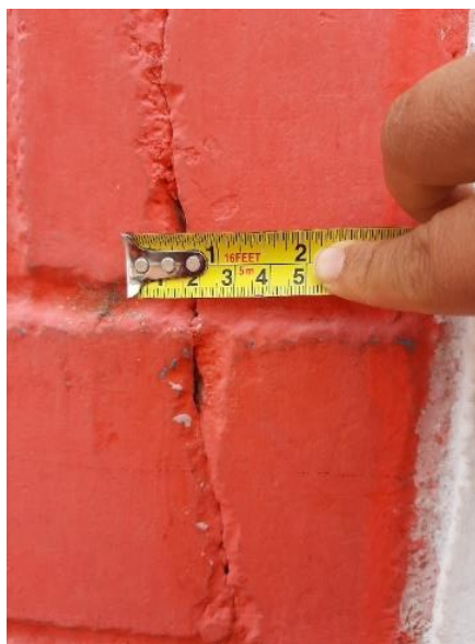
Figura 22. estado de conservación del pabellón B
