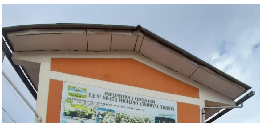
Figura 13. Elementos no estructurales del pabellón A. Fuente: Elaboración propia
