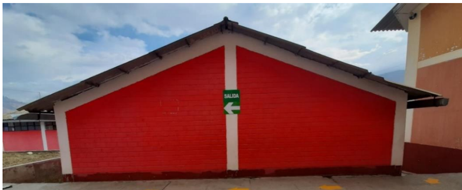
Figura 20. estado de conservación del pabellón B. Fuente: Elaboración propia
