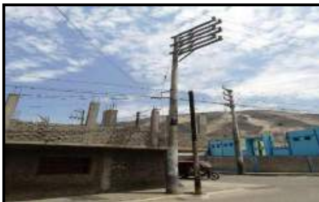
Figura 4. Estructura red primaria donde se incumple la distancia de seguridad debido a las construcciones nuevas. No hay espacio para la retenida vertical.
