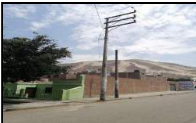
Figura 3. Estructura de red primaria con retenida cortada
