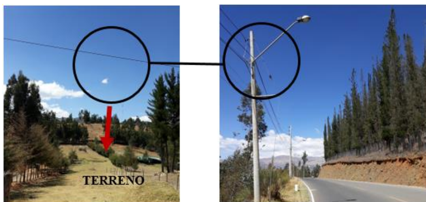
Figura N° 19: Ubicación de puntos de Energía Eléctrica Transformada
