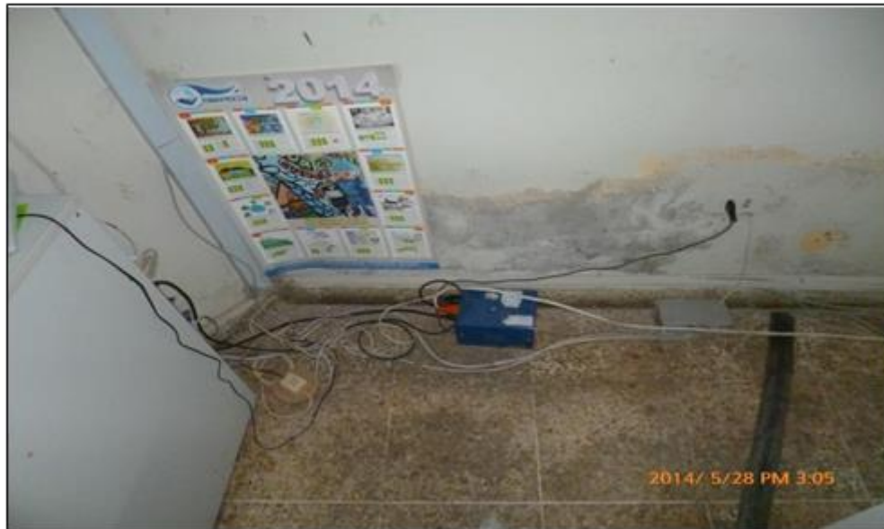
Figura N° 10. Estado actual de la red de datos de laboratorio N° 02 Fuente. Elaboración propia
