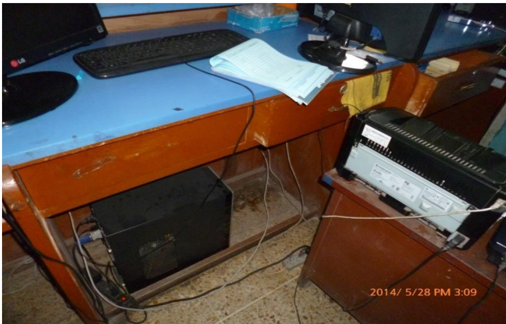
Figura N° 12. Estado actual de la red de datos de Mecánica Automotriz Fuente. Elaboración propia
