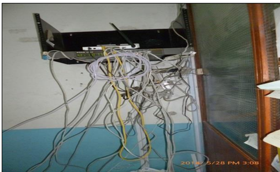
Figura N° 08. Switch de distribución para las diferentes áreas. Fuente. Elaboración propia.
