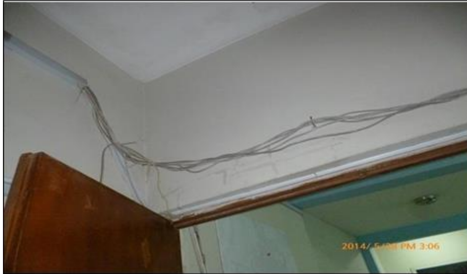
Figura N° 09. Estado actual de la red de datos de laboratorio N° 01 Fuente. Elaboración propia
