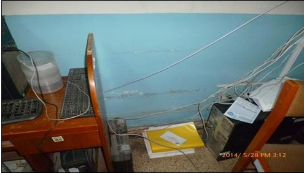
Figura N° 11. Estado actual de la red de datos de Mecánica Automotriz Fuente. Elaboración propia
