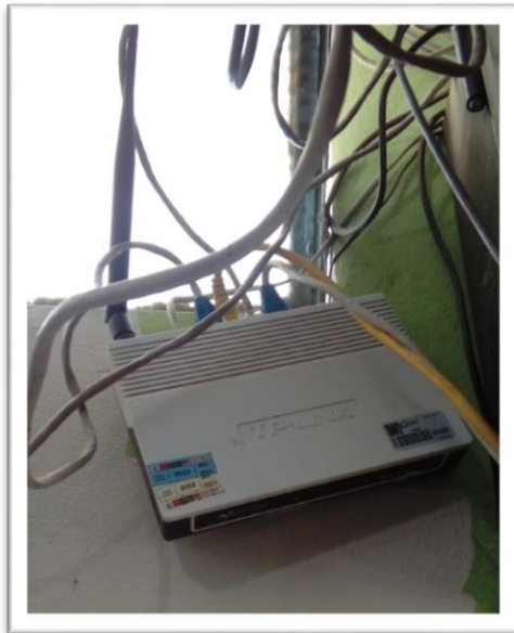
Figura 28. Router convencional que se usa para la distribución de la red.
