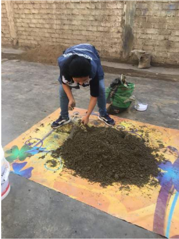
FIGURA N° 70: Elaboración de la mezcla para la fabricación de los ladrillos experimentales Fuente: Propia
