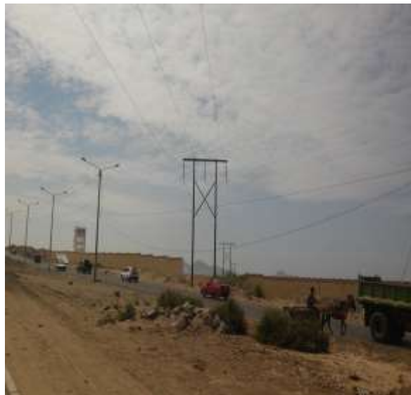
Línea de Transmisión de 138 kv que pasa por el Campus 2 de la UNS.
