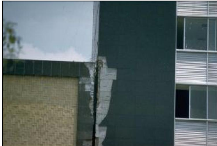
Figura 4.06 Daño producido por el impacto entre dos edificios de hormigón armado adyacentes, durante el sismo de México, 28 de Julio de 1957. (Fuente: http://nisee.berkeley.edu )
