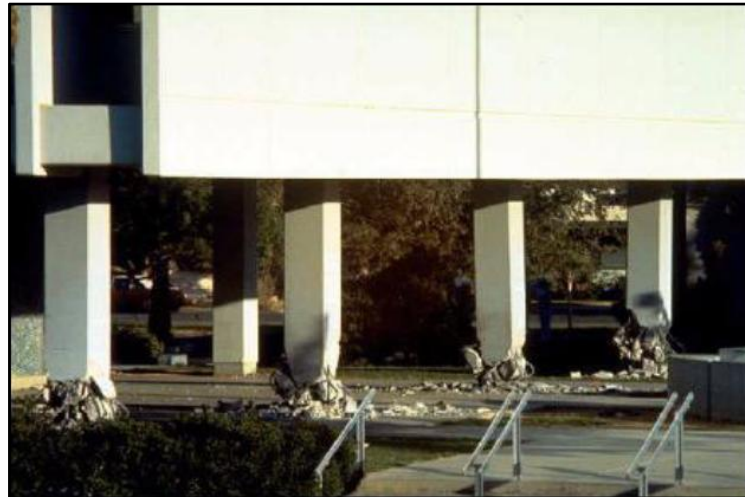
Figura 4.03 Fallo explosivo de las columnas del primer nivel, 15 de octubre de 1979 (Fuente: ( http://nisee.berkeley.edu ).)
