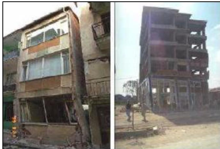
Figura 4.05 Daños producidos por las derivas excesivas en la planta baja de dos edificios aporricados de hormigón armado - Sismo de Izmit, Turquía, 17 de Agosto de 1999. (Fuente: http://nisee.berkeley.edu )
