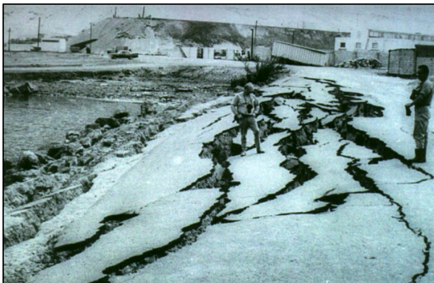
Figura 2.16. Asentamientos y fisuramientos de carretera asfaltada debido a compactación y desplazamiento lateral de depósitos lagunares y de playa. Chimbote (Fuente: 2011 Terremoto del 31 de mayo. Alva J)
