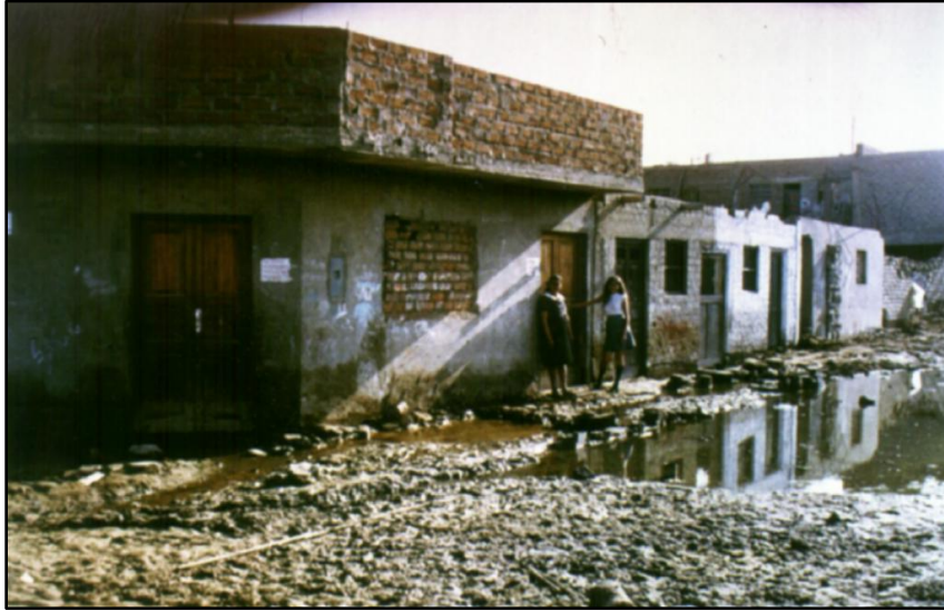
Figura 2.15. Inundación de área residencial en el sureste de Chimbote debido al asentamiento y compactación del terreno. Chimbote (Fuente: 2011 Terremoto del 31 de mayo. Alva J)
