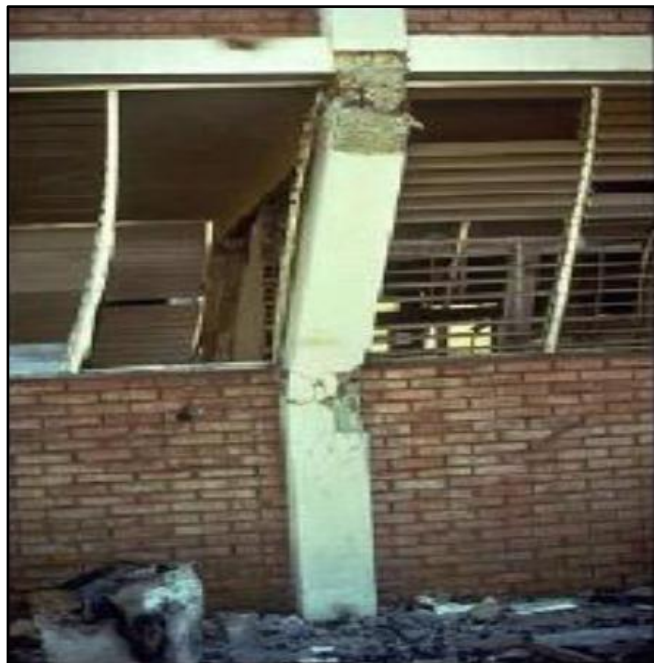
Figura 4.04 Fallo de columna corta producido por la mampostería de relleno y las Ventanas (Fuente: http://nisee.berkeley.edu )
