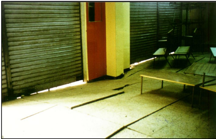
Figura 2.13. Agrietamiento de pavimentos y cimentaciones por compactación diferencial en el centro de Chimbote. Chimbote (Fuente: 2011 Terremoto del 31 de mayo. Alva J)
