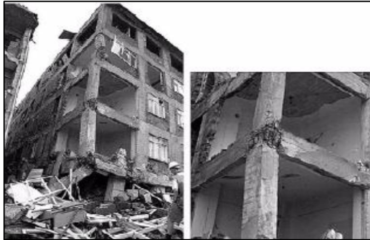
Figura 4.07 Daños producidos en edificios por el comportamiento no dúctil de las vigas de hormigón armado - Sismo de Turquía, 17 de Agosto de 1999 (Fuente: Sezen 2003 et al)
