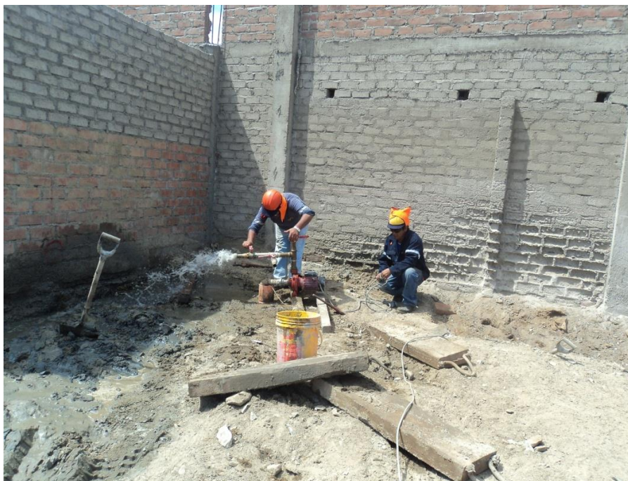
Instalación de Motobomba de agua en poza de agua subterránea.
