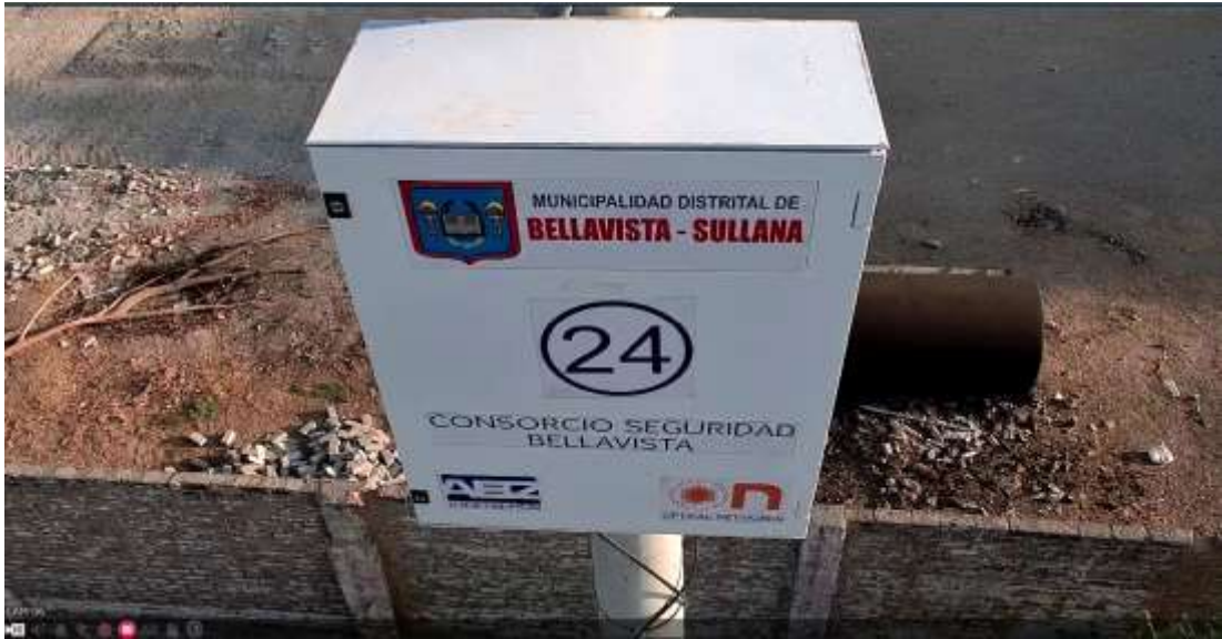
Figura 04: TABLERO DE COMUNICACIONES ENTRE CAMARA Y DATA CENTER Fuente: Elaboración Propia
