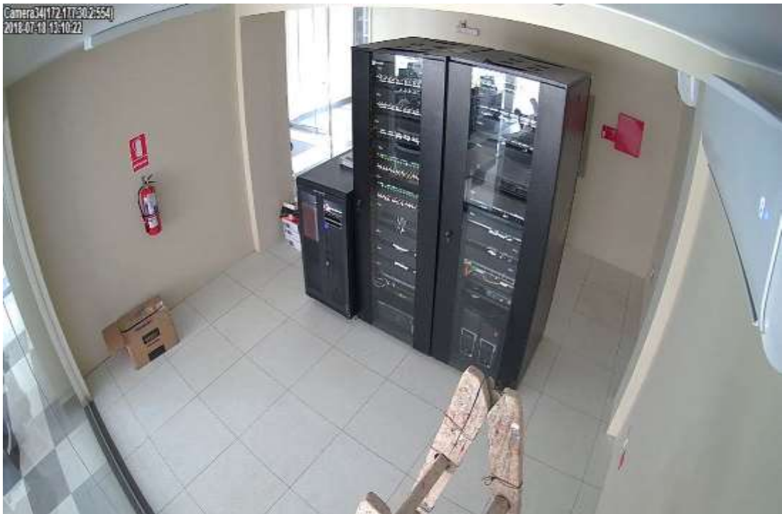
Figura 03: DATA CENTER DEL COEM - BELLAVISTA Fuente: Elaboración Propia
