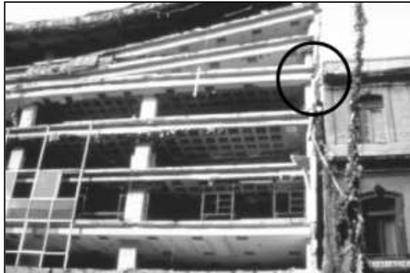
FIGURA No.10 Falla por no tener junta sísmica
