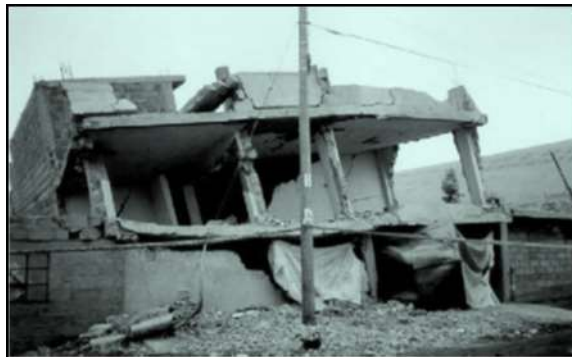
FIGURA No. 11 Mal confinamiento de muros
