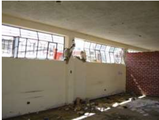
FIGURA No. 7 Falla de Columna Corta
