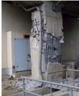
FIGURA No. 8 Falla por falta de estribos
