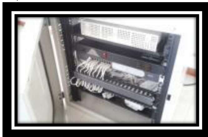
Fig. 23. Router, Switch y Patch Pannel Fuente. Optronics
